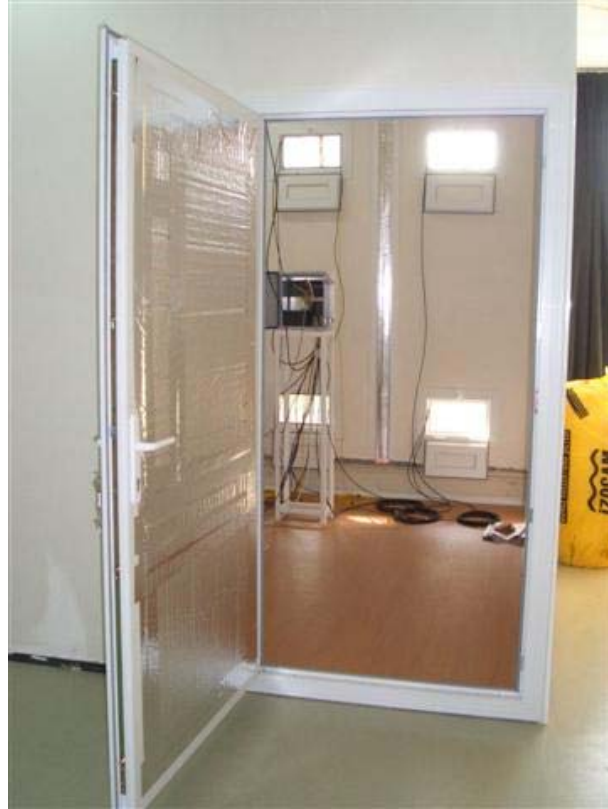
Şekil 4.10 PVC kapı ve menfezlerin takılıp, sıkıştırılmış camyünü ile yalıtılması; Tavan ve tabanın XPS, laminat parke ve PVC plakalarla yalıtılması.
