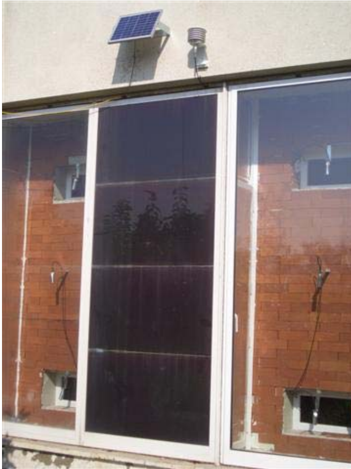
Şekil 4.12 Datalogger'in bataryasını şarj eden PV ile dış ortam sıcaklık ve nem sensörünün dış cidara yerleştirilmesi.
