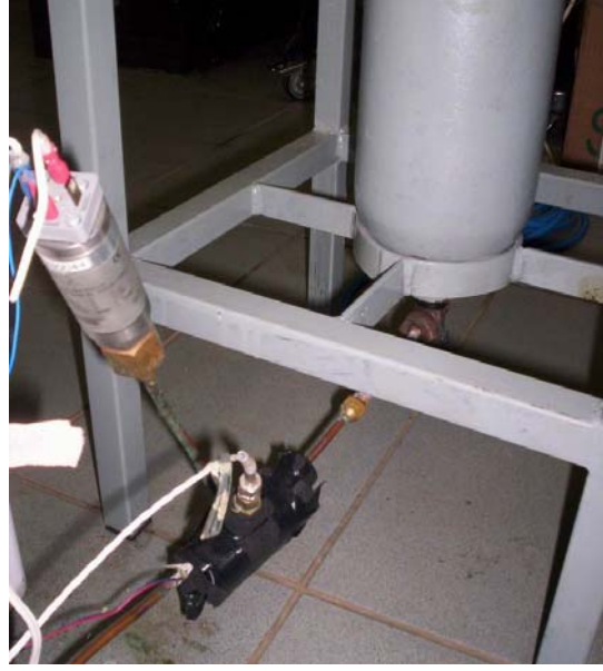
Şekil 3.16 : Tank sıcaklık ve basınç ölçüm noktaları
