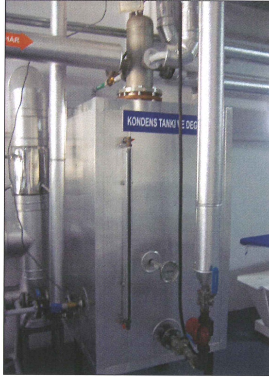
Şekil 3.5 : Deney Tesisatında Kullanılan Kondens Tankı ve Degazör
