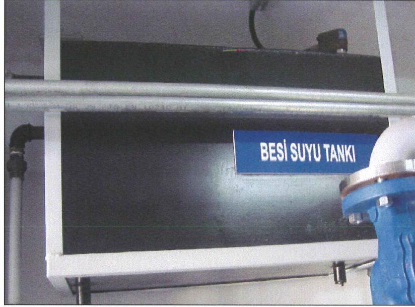
Şekil 3.3 : Deney Tesisatında Kullanılan Kondens Tankı
