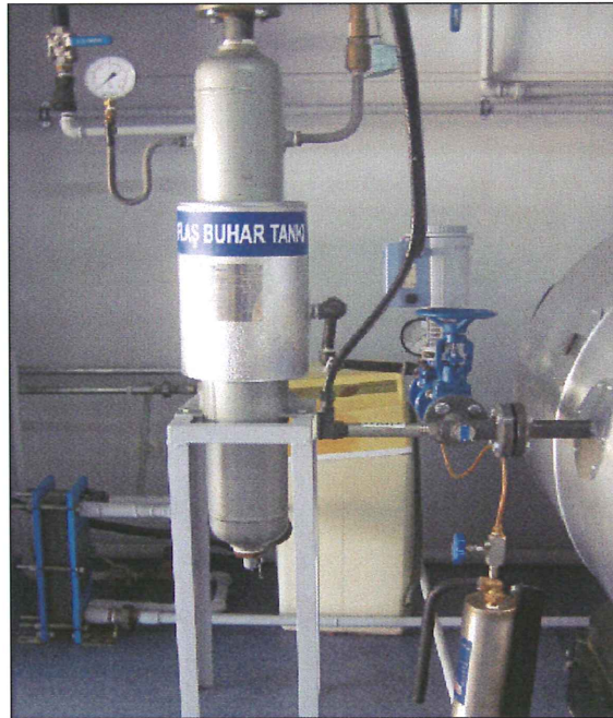
Şekil 3.7 : Deney Tesisatında Kullanılan Flaş Buhar Tankı
