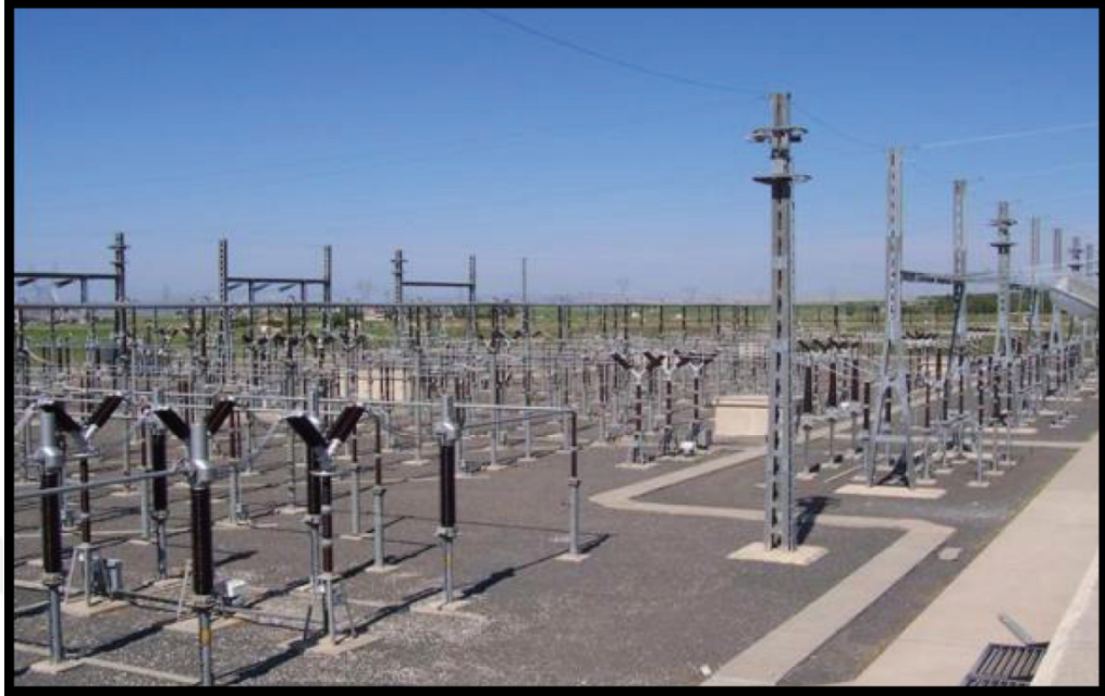
Şekil 3.34. Şalt sahası görünüşü.
