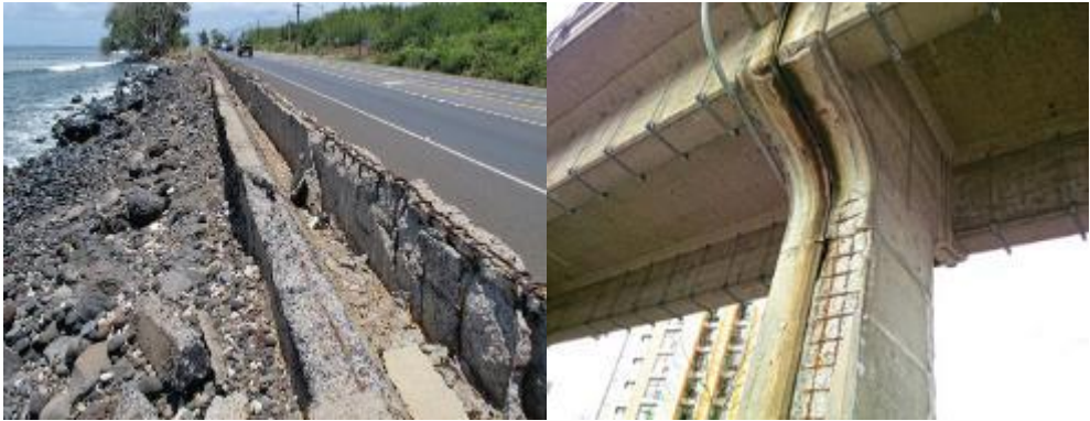
Şekil 3.8. Korozyona uğramış yapı elemanları [1, 23].
