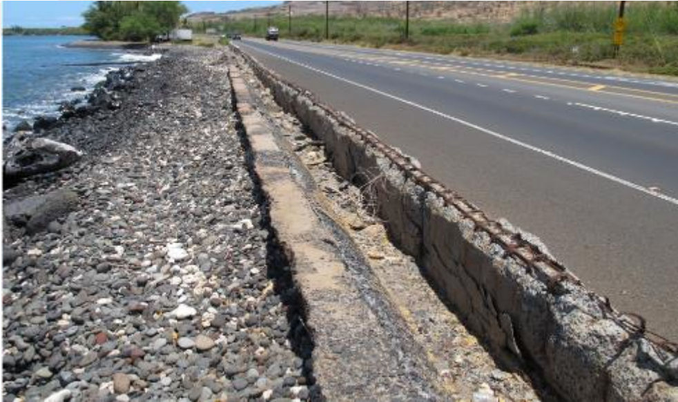
Şekil 3.10. Beton yapı elemanlarında çelik donatı korozyonu [1].
