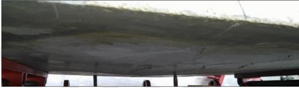
Şekil 4.81. GFRPK donatılı döşeme kırılma detayı
