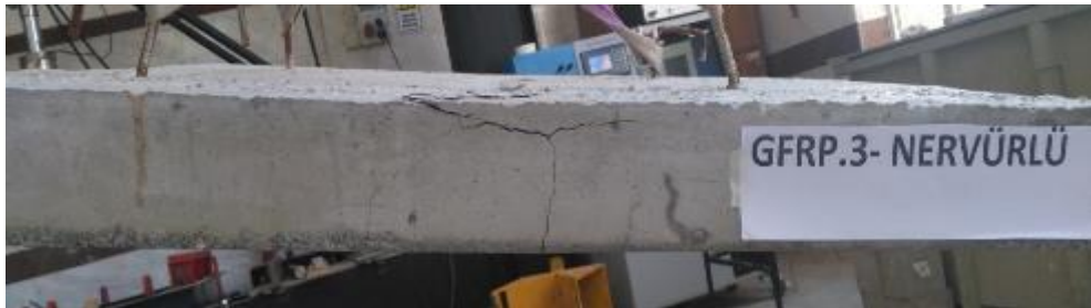
Şekil 4.83. GFRPN donatılı döşeme kırılma detayı
