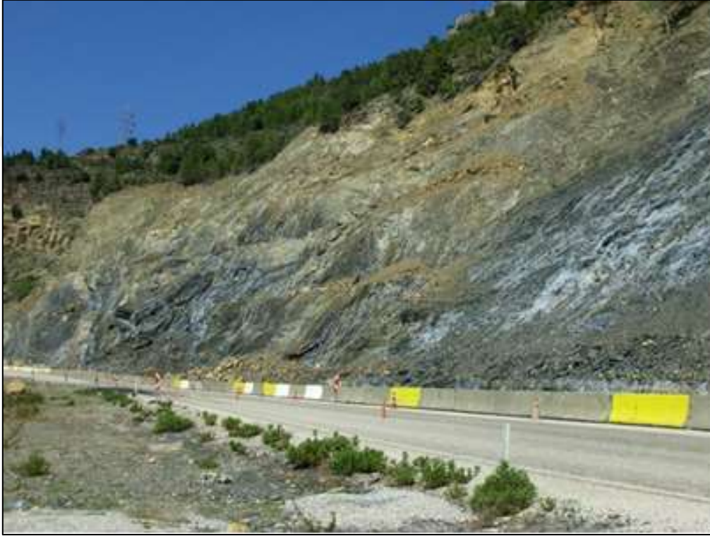
Şekil 4.1. Çalışma alanında duraysızlık problemi yaşanan mevcut şevin genel görünümü.
