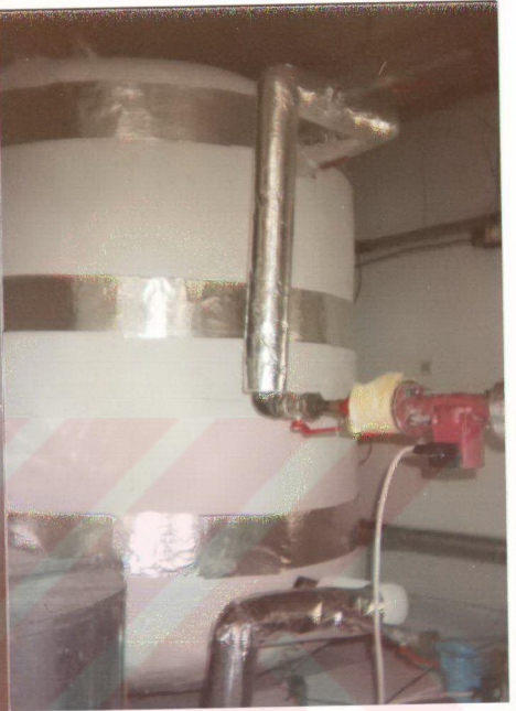
Isı Depolama Ünitesi (5 m 3 tank)
