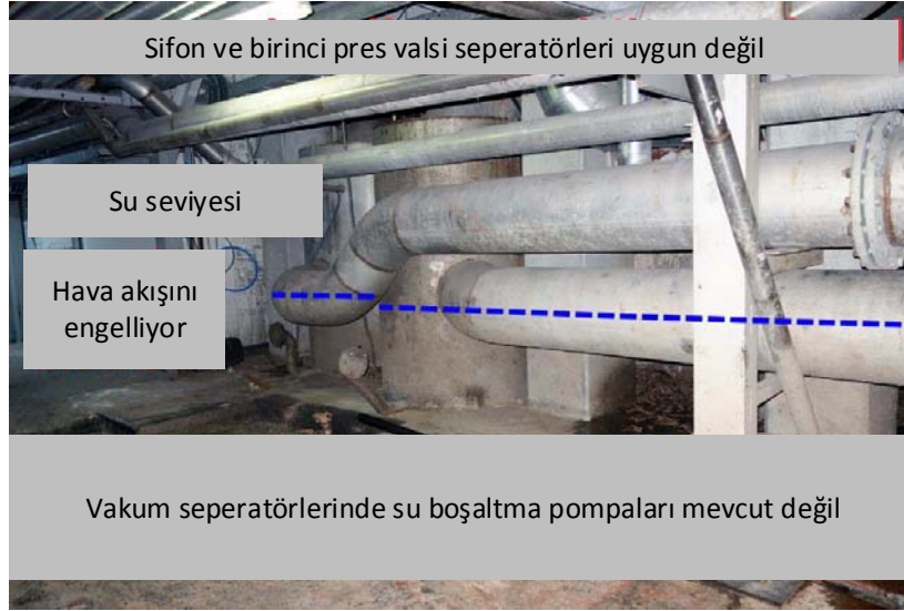
Şekil 6. 27 Vakum borulama uygunsuzlukları
