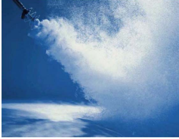
Şekil 6. 46 Biyolojik arıtmada jet aeratörle suyun hava verilerek karıştırılması
