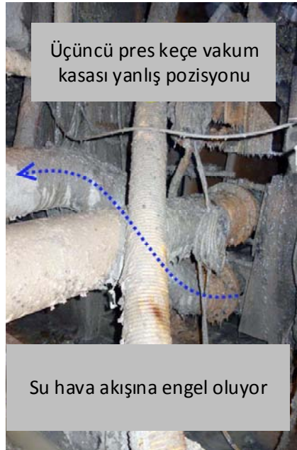
Şekil 6. 30 Vakum borulama dizayn hatası
