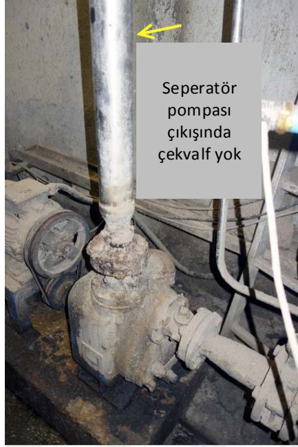
Şekil 6. 26 Keçe tahliye pompası dizayn hatası
