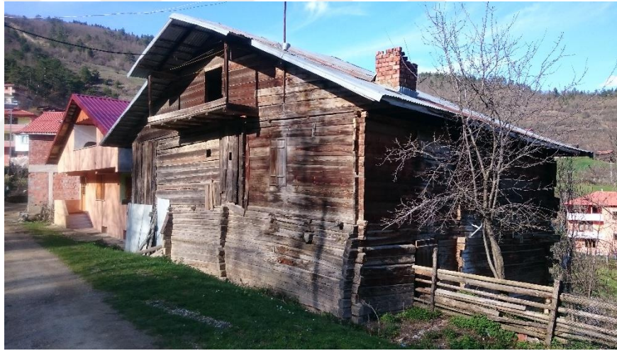
Şekil 3.131. Çatısı sac kaplanmış, bacası hasar görmüş bir ev / Gökçeler Mah.
