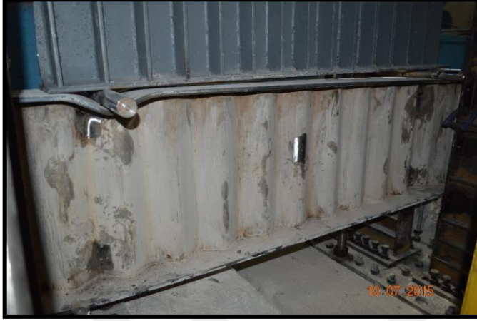
Şekil 4.28. OGK_500_Test_9 lokal ezilme durumu
