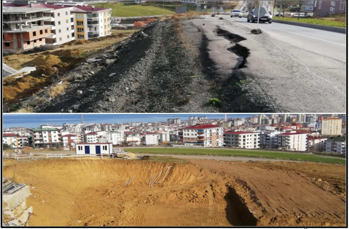
Şekil 54. Recep Tayyip Erdoğan Bulvarı üzerinde gerçekleşen çökmeler(Üstte) ve bulvarın alt kısmında devam eden inşaat çalışmaları(Altta)
