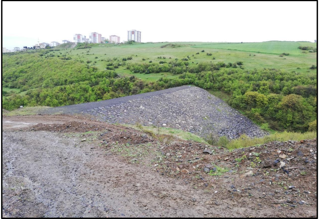
Şekil 49. Afanlı Deresi üzerinde inşa edilen sel kapanından bir görünüm
