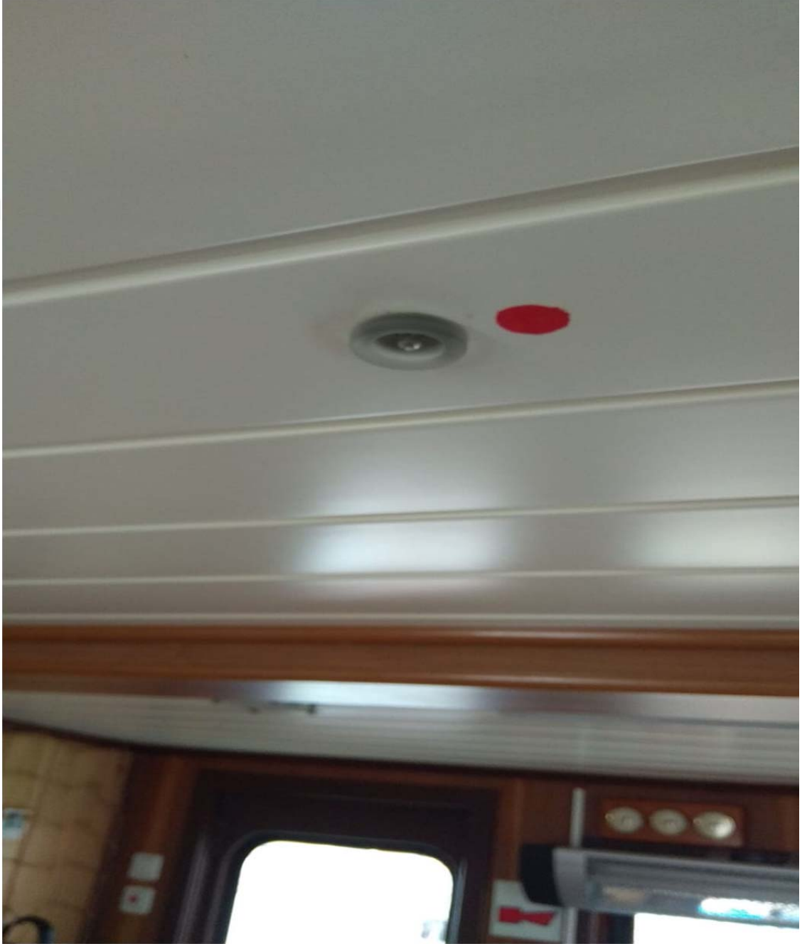
Şekil 4.13.1. 24 volt enerji ile çalışan aydınlatma sistemi
