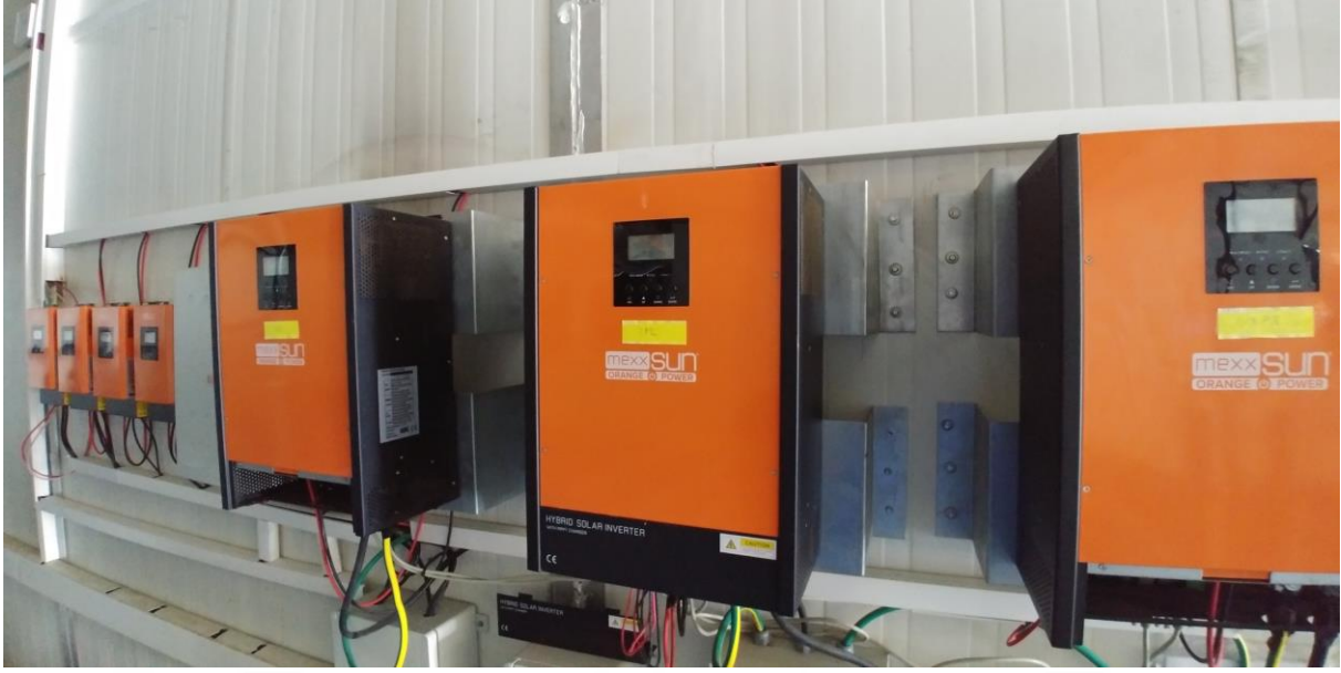
Şekil 3.9. Tatlısu balık işletmesi hibrid solar inverterler ve şarj regülatörleri
