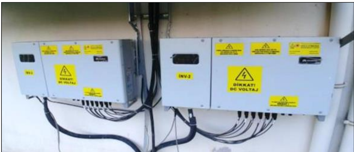
Şekil 3.7. PV güneş panel sisteminde kullanılan invertörlere ait görünüm
