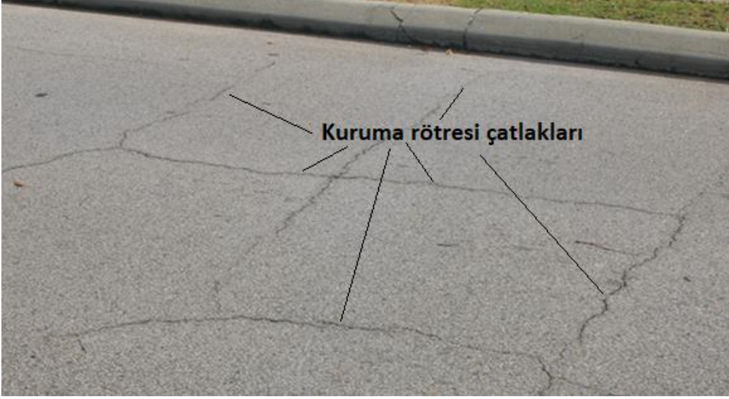
Resim 1.3.1. Beton yol kaplamasında kuruma r tresi  atlaklı (URL-2, 2023)
