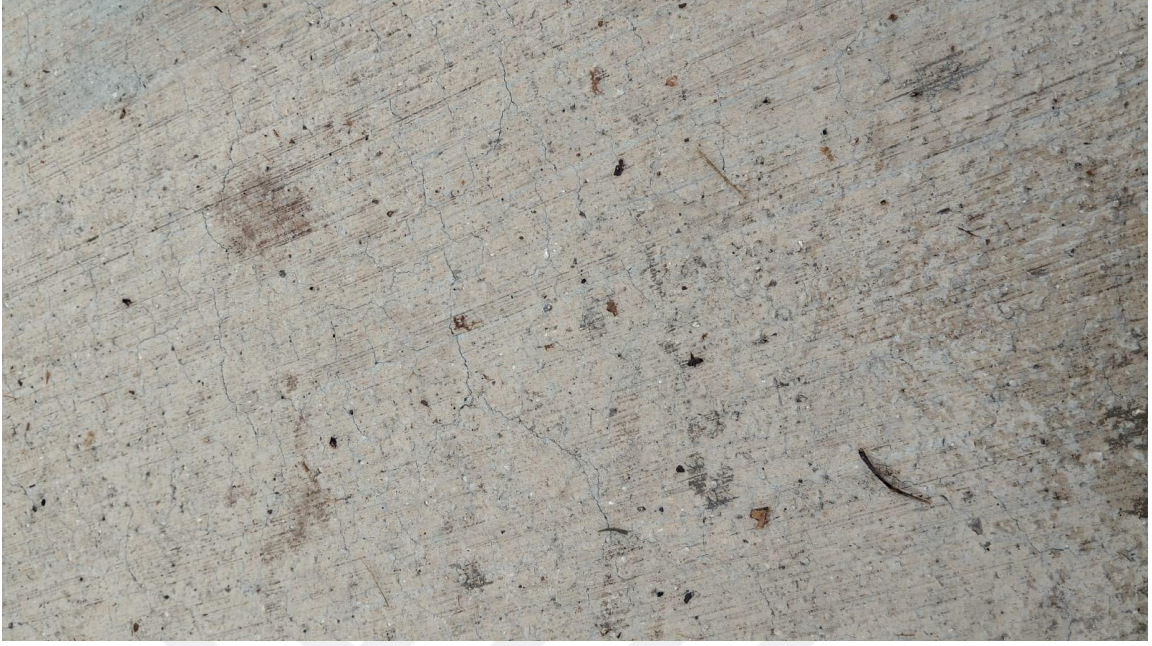
Resim 1.2.1. Betonda oluşan rötre çatlağı
