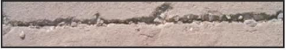
Resim 1.3.3. Doğru olmayan derz kesimi (T.C. Ulaştırma Denizcilik ve Haberleşme Bakanlığı, 2016)
