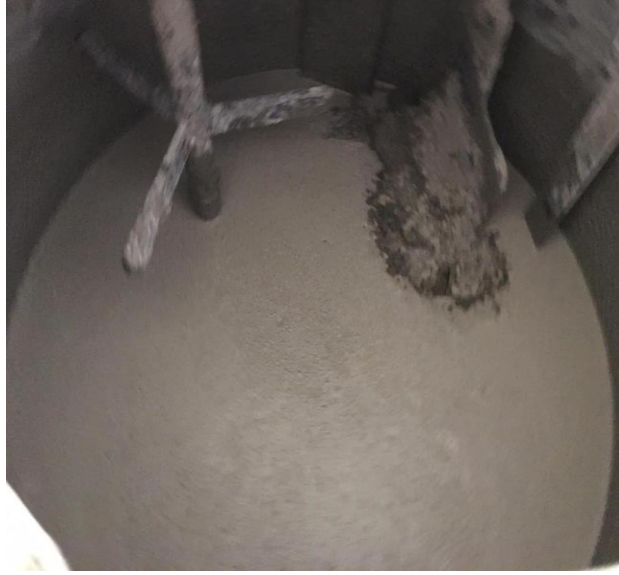
Şekil 4. 9. Su kusan beton.
