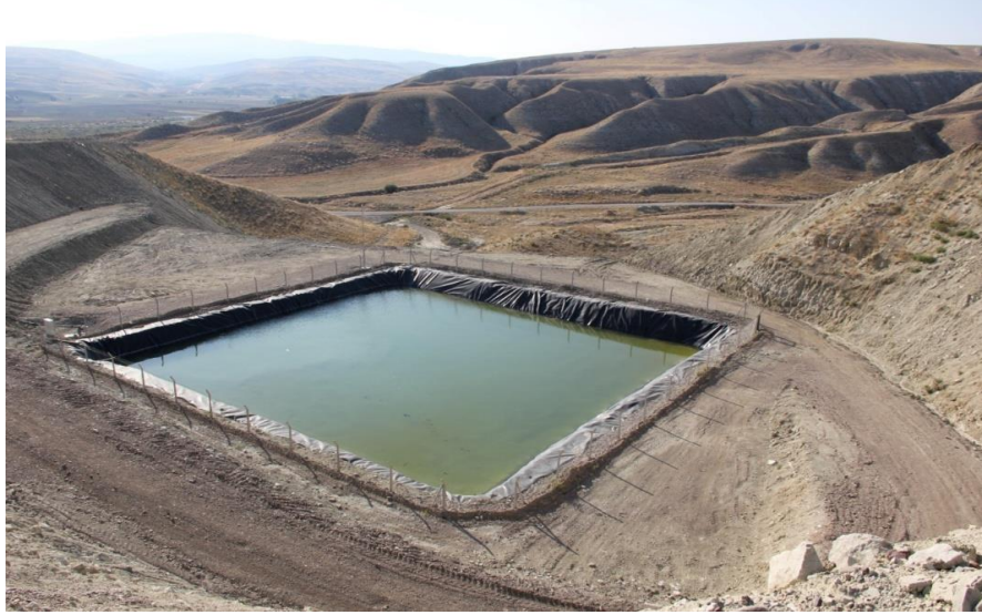
Şekil 4.3: Düzenli depolama sahası sızıntı suyu havuzu.
