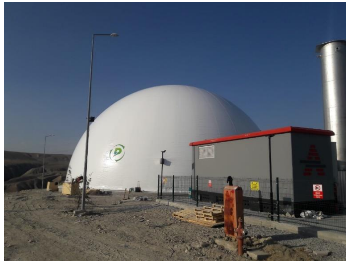
Şekil 4.4: Elektrik üretim tesisi.
