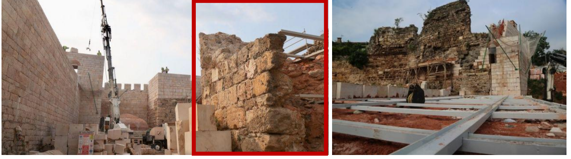
Şekil 3.202. Restorasyon sırasında binaya yapılan yeni çağdaş eklerin yanı sıra özgün yapı malzemelerini gösteren fotoğraflar, (Haber, n.d.) (İstanbul, 2017)
