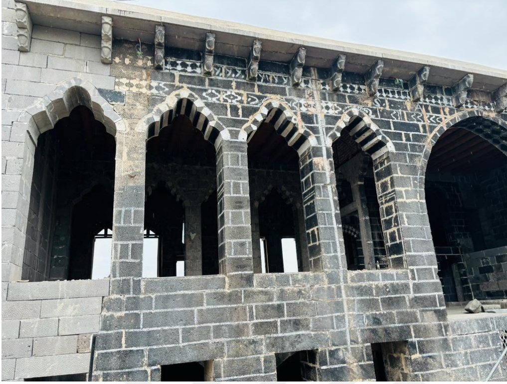
Fotoğraf 52. Konut 8'in Güney Cephesinde Pencere Nişlerinin Görünümü
