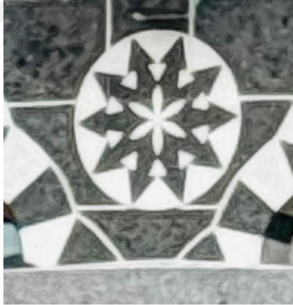
Fotoğraf 26. Konut 3'ün Güney Cephesindeki Rozet Süsleme Detayı
