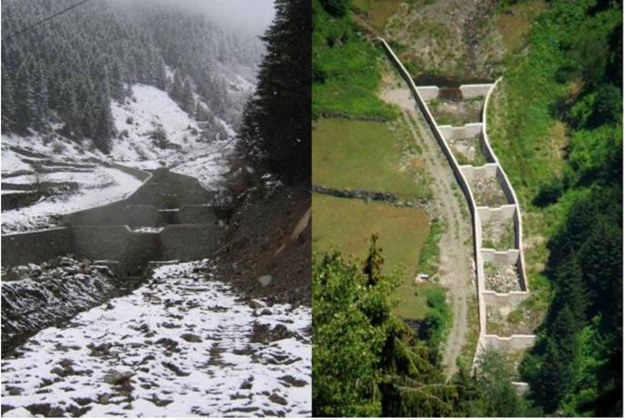
Şekil 8: Uzungöl Yan Derelerde Yapılan Tersip Bentler
