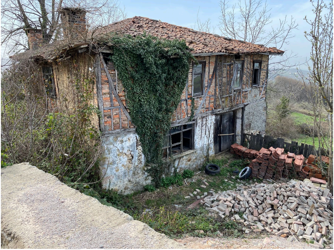
Şekil 6.18. Nüzhetiye Köyü’nde Bulunan Terk Edilmiş Bir Tescilli Yapı, Yapıyı Saran Bitkisel Öğeler
