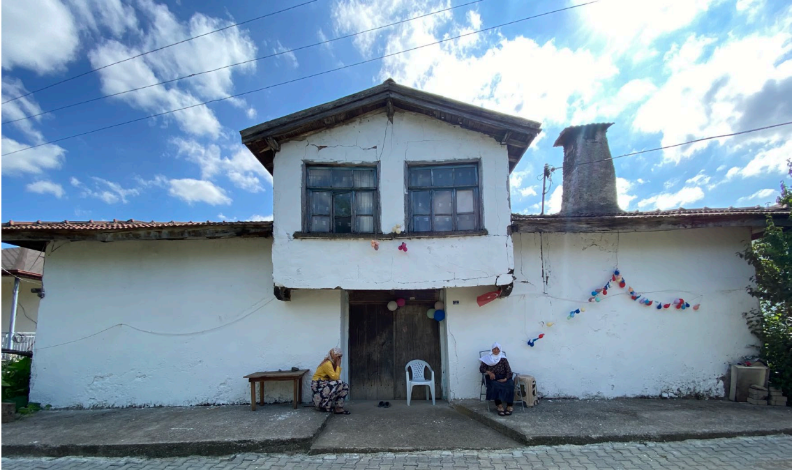
Şekil 6.14. Nüzhetiye Köyü'nde Bulunan Tescilli Yapı, Cumbadaki Ahşap Elemanın Sehim Hareketi ve Sıva Çatlakları
