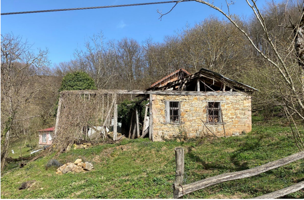
Şekil 6.15. Nüzhetiye Köyü'nde Bulunan Terk Edilmiş Bir Tescilli Yapı
