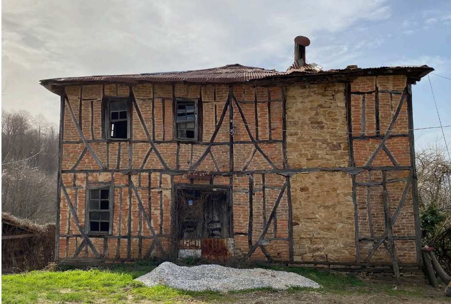
Şekil 6.16. Nüzhetiye Köyü'nde Bulunan Terk Edilmiş Bir Tescilli Yapı
