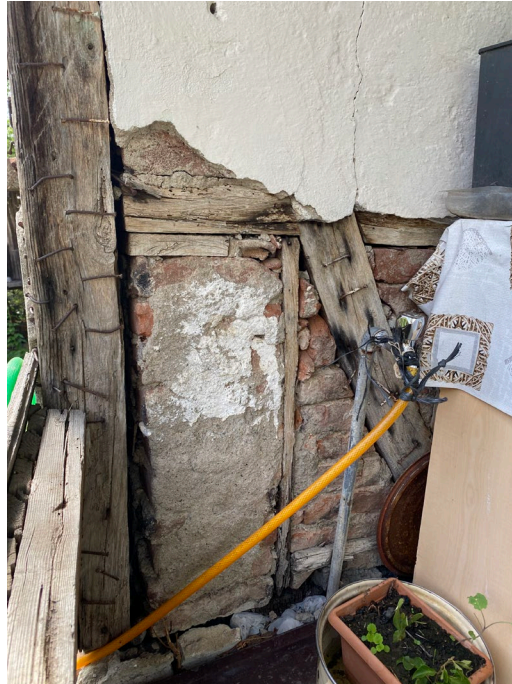
Şekil 6.12 Yapıya Ait Bozulma Fotoğrafı, Yapının Köşeden Açılması
