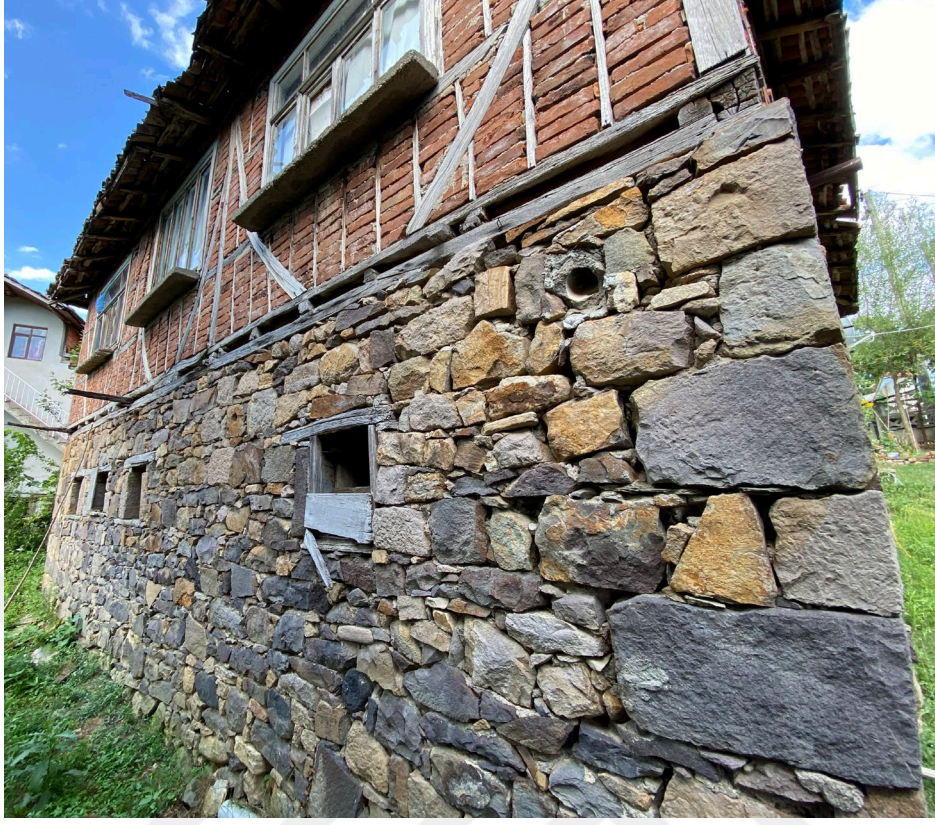
Şekil 6.13. Yapıya Ait Bozulma Fotoğrafı, Yapının Bodrum Katındaki Yığma Taş Beden Duvarlarının Ara Harçlarının Atması ve Dere Taşıyla Doldurulması
