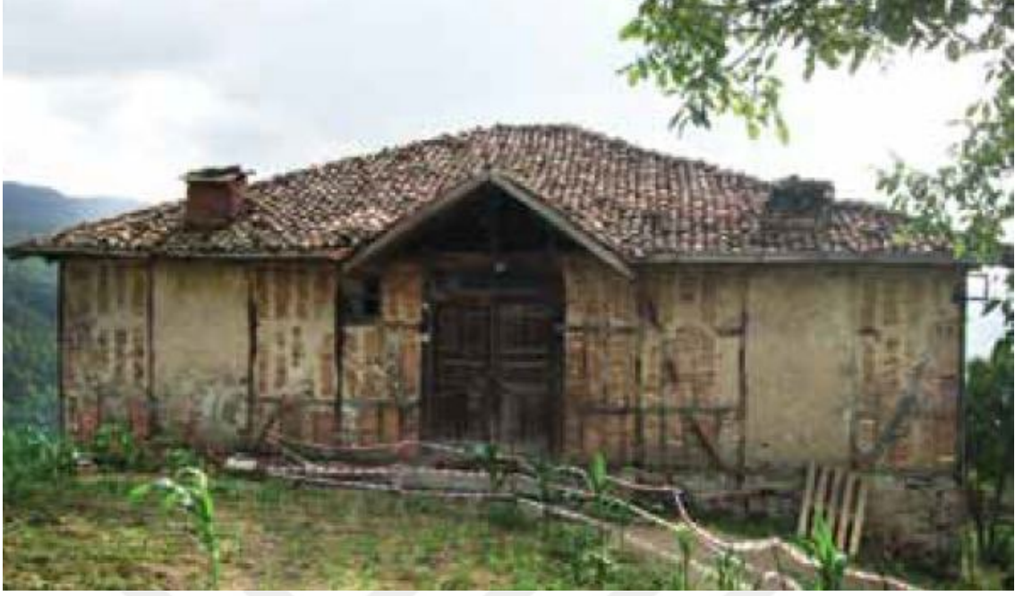
Şekil 6.19. Nüzhetiye Köyü'nde Bulunan Terk Edilmiş Bir Tescilli Yapı, 2013 (Köksal, 2013)
