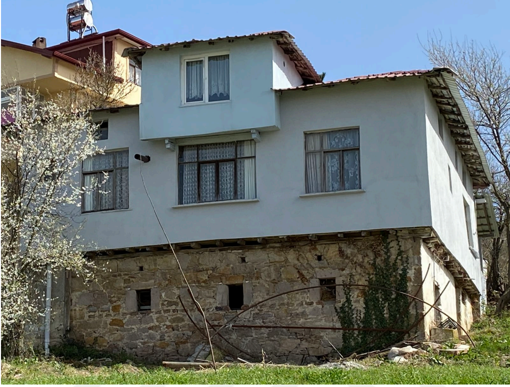
Şekil 6.5. Nüzhetiye Köyü’nde Tescilli Bir Yapıdaki Muhdes Pencere Elemanı ve Çimento Bazlı Sıvası
