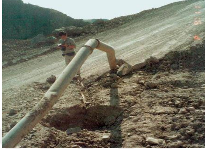
Şekil 2.5: Ters faylanma nedeniyle oluşan boru hattı hasarı ( Manjil, 1990 ).
