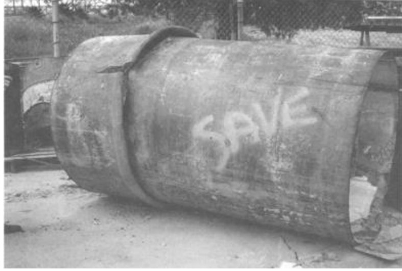
Şekil 2.6: Kaynaklı çelik boru hasarı (Los Angeles, 1994).
