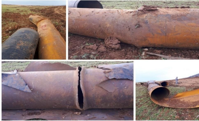
Şekil 2.11: Maraş Depreminde Boru Hasarları (Gölbaşı 2023).
