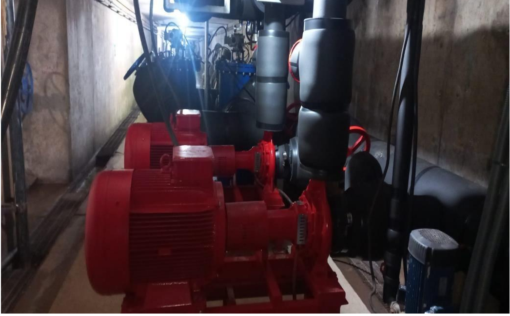
Şekil 2.13. Yeni yangın pompaları ve jokey pompa
