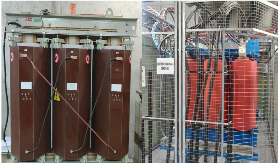
Şekil 2.6. Eski ve yeni iç ihtiyaç trafoları
