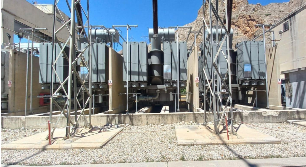
Şekil 2.18. Yeni ana güç trafoları
