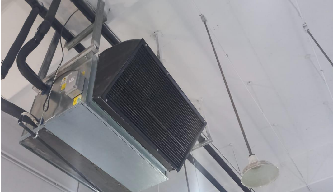
Şekil 2.15. Fancoil sistemiyle trafoların soğutulması işlemi
