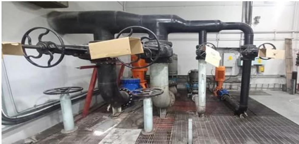
Şekil 2.12. Drenaj sistemi eski ve yeni pompalar
