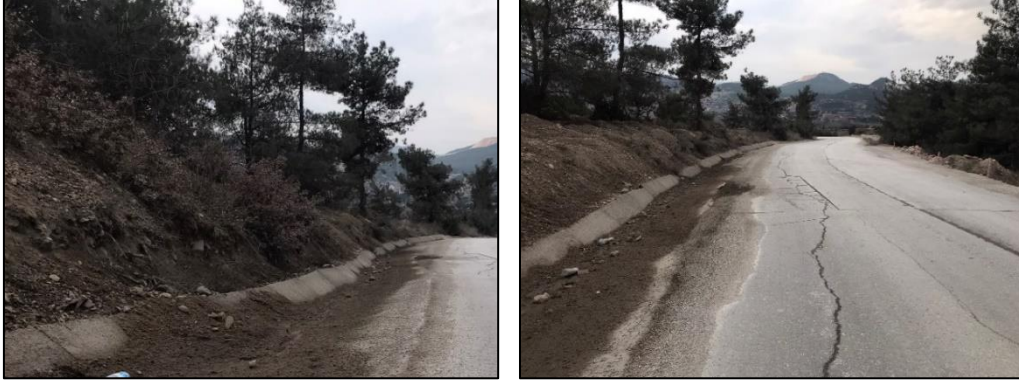
Resim 4.1. Çalışmayan drenaj sistemi ve bozulma oluşumu: Bilecik, Ocak 2023
