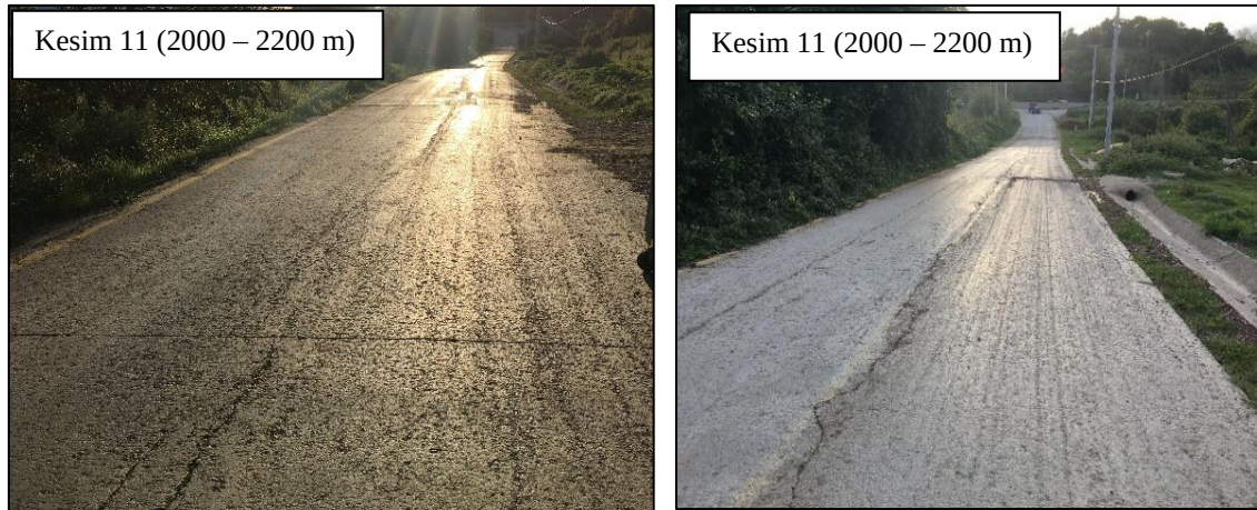
Resim 5.2. Agrega cilalanması ve düşük şiddette doğrusal çatlak oluşumu
