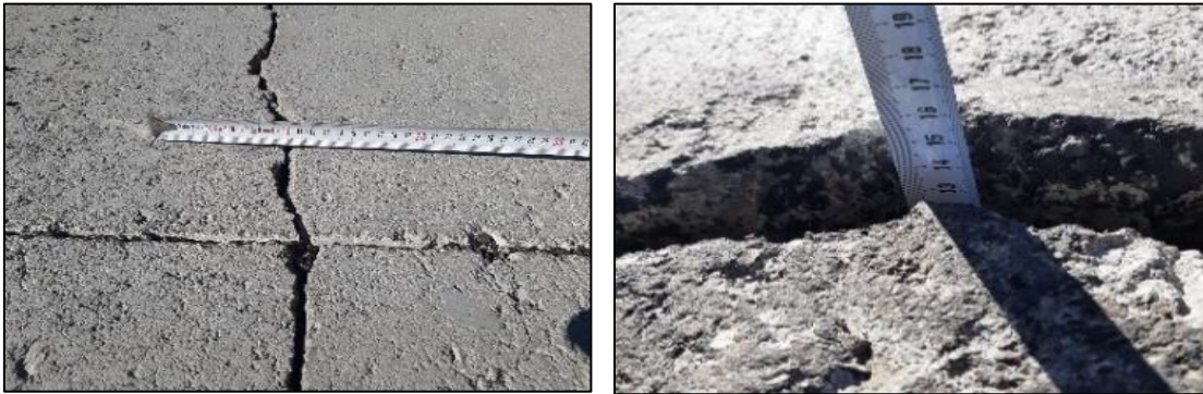
Resim 3.31. Çatlak şiddetinin belirlenmesi: Burdur, Aralık 2021
