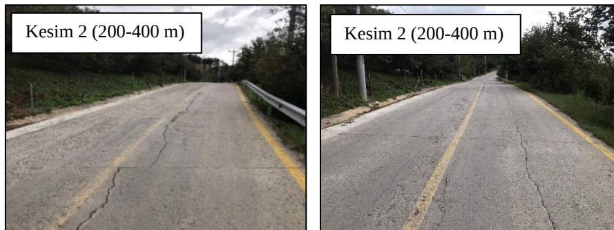
Resim 5.5. Eşmeahmediye-Avluburun SSB yolu doğrusal çatlak oluşumu
