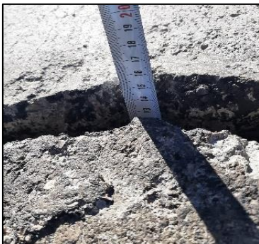
Resim 3.30. Yüksek şiddetli faylanma örneği: Burdur, Aralık 2021
