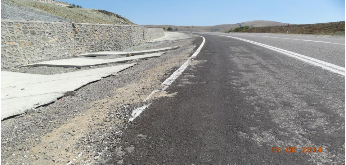
Şekil 4. 9. İksa duvarında meydana gelen çatlaktan görünüm-3
