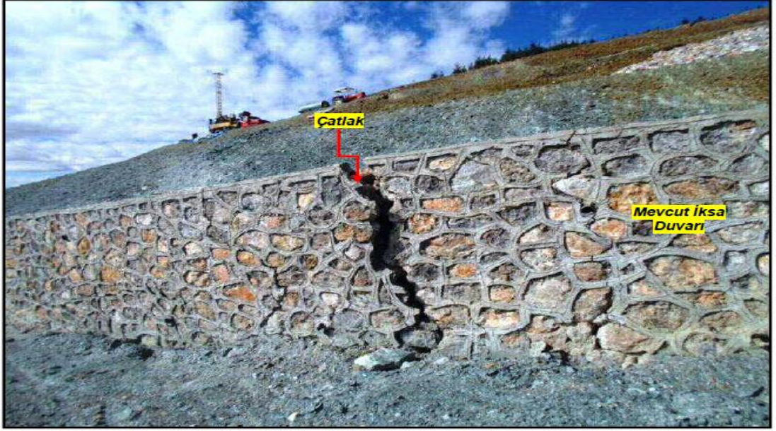
Şekil 4.7. İksa duvarında meydana gelen çatlaktan görünüm-1
