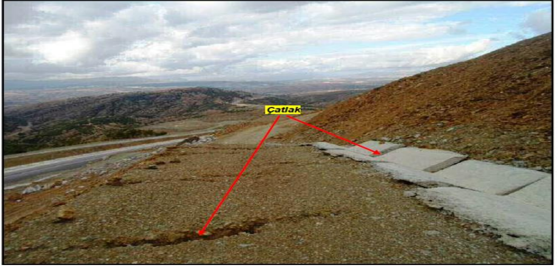
Şekil 4. 11. Heyelan sahasında oluşan derin çatlaklardan genel görünüm-2
