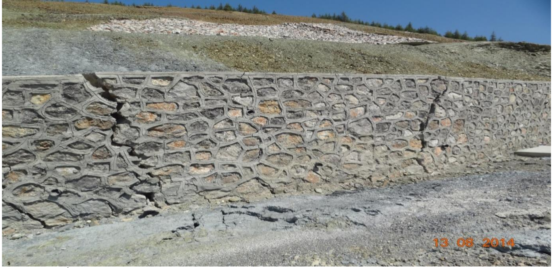
Şekil 4. 8. İksa duvarında meydana gelen çatlaktan görünüm-2
