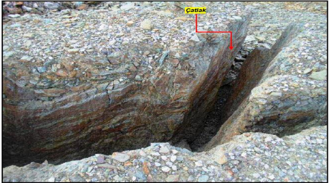
Şekil 4. 10. Heyelan sahasında oluşan derin çatlaklardan genel görünüm-1
