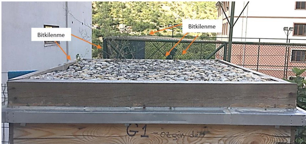
Şekil 6.38 G1 kodlu damın 1 yıl sonunda yüzey görünümü (Temmuz-2023)
