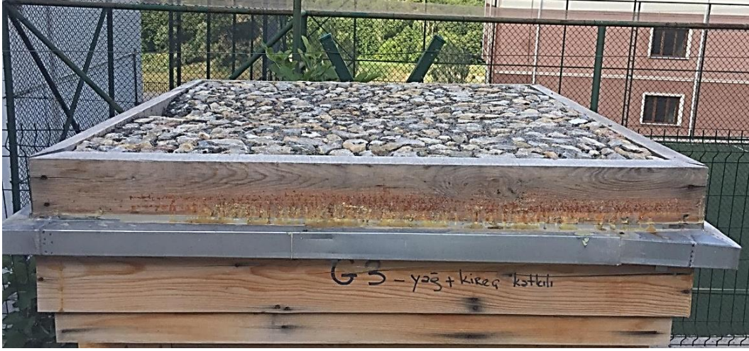
Şekil 6.39 G3 kodlu damın 1 yıl sonunda yüzey görünümü (Temmuz-2023)
