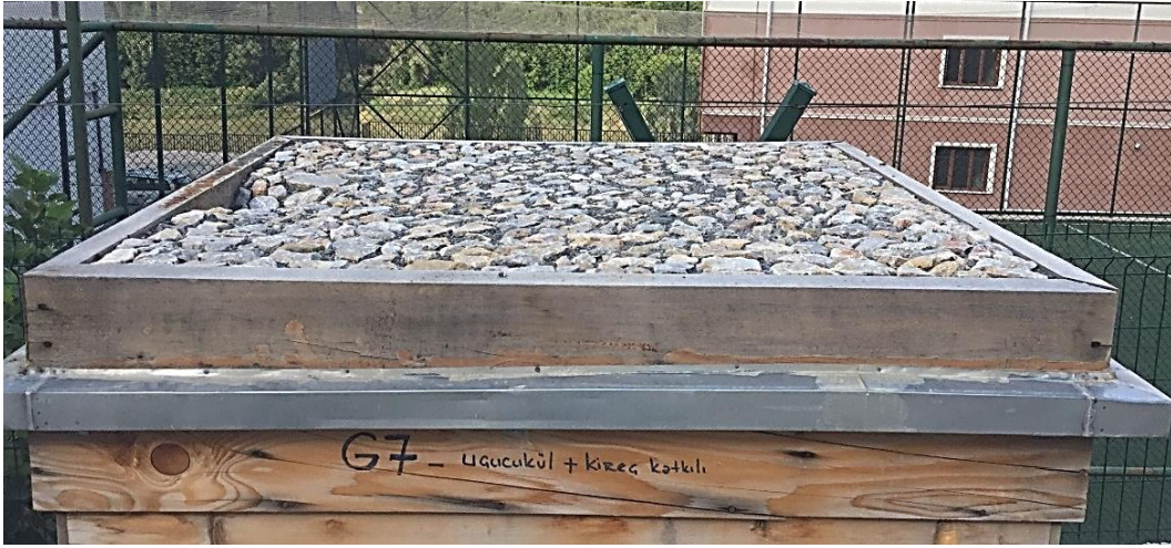
Şekil 6.40 G7 kodlu damın 1 yıl sonunda yüzey görünümü (Temmuz-2023)
