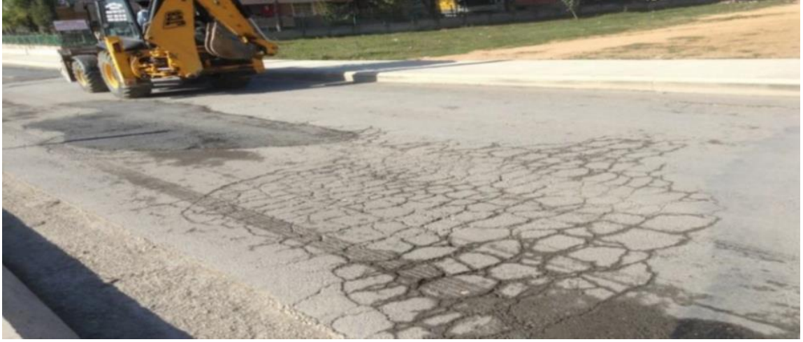
Şekil 4. Timsah sırtı (yorulma) çatlakları
