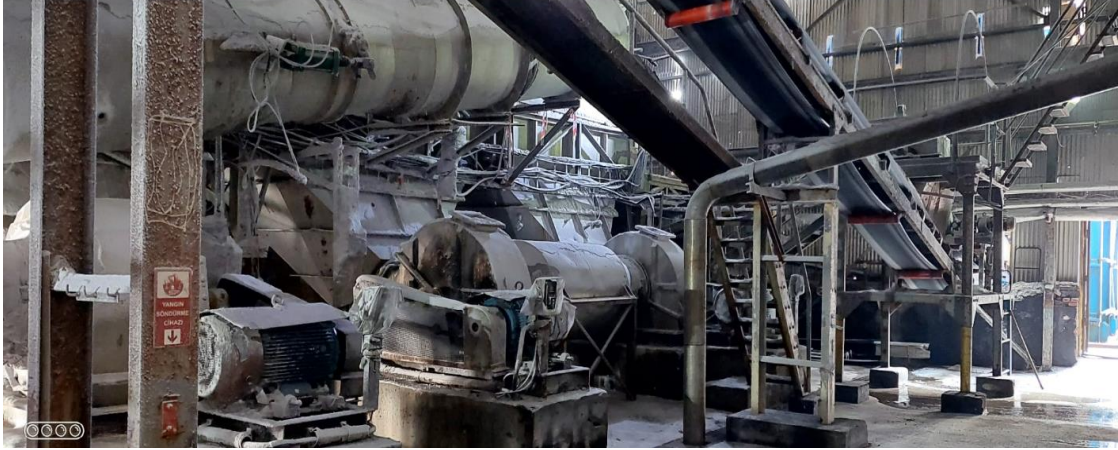
Şekil 3.2. Nitrik asit üretim tesisi (Kütahya Gübre Sanayii A.Ş.).
