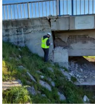
Fotoğraf 3.8 Köprü ayağında gözlemlenen hasar
