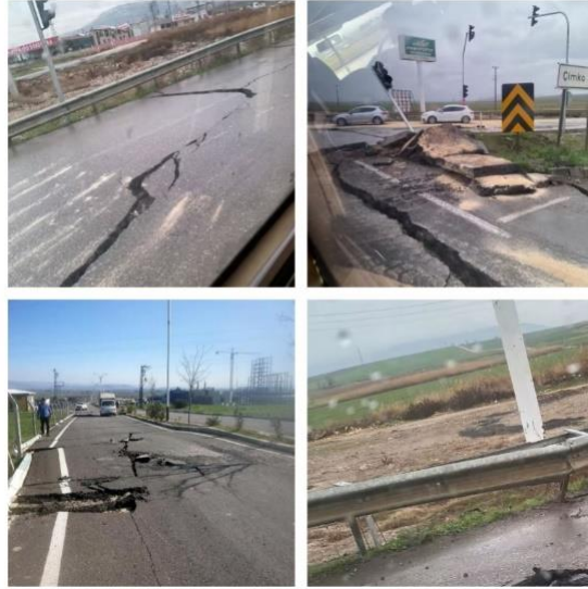
Fotoğraf 3.2 Otoyol kaplamasında meydana gelen hasarlar
