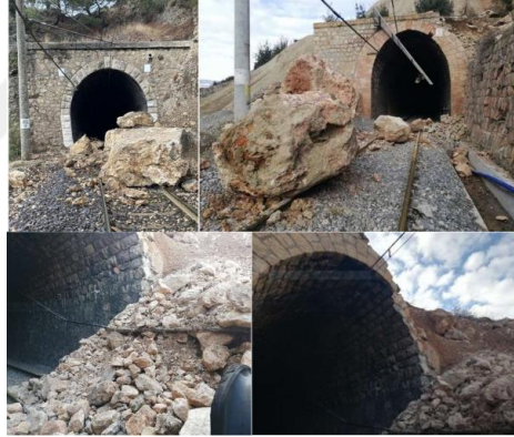
Fotoğraf 3.40 Demiryolu tünel giriş/çıkışlarında kaya düşmesi hasarı
