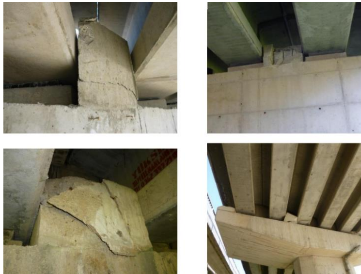
Fotoğraf 3.31 Hasar gören deprem takozları
