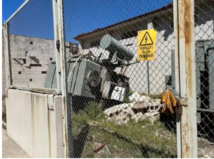
Fotoğraf 3.90 Yetersiz sabitleme nedeniyle devrilen trafo
