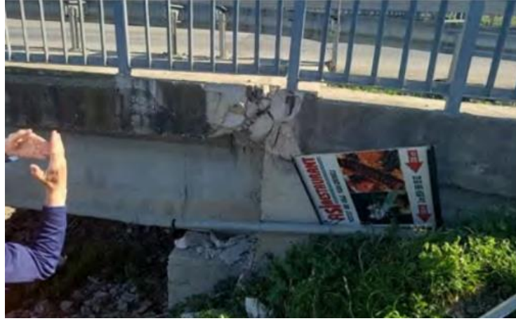
Fotoğraf 3.23 D817 Köprüsünde gözlemlenen hasar
