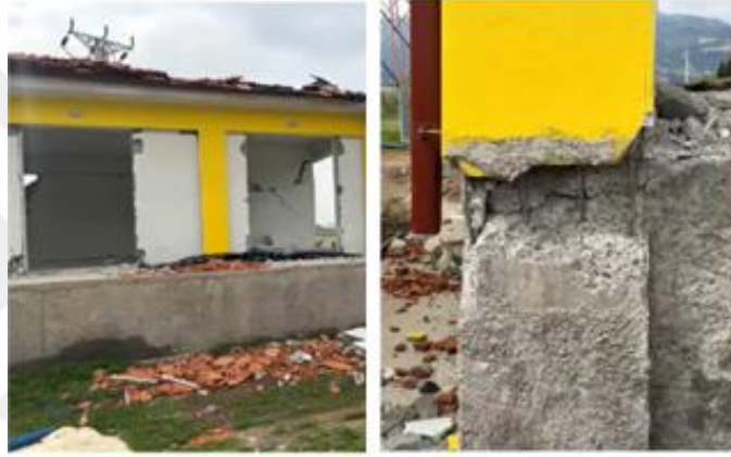
Fotoğraf 3.85 Hasar gören trafo merkezi binasının yakından görünümü
