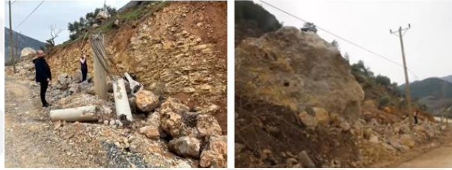
Fotoğraf 3.93 Kaya düşmesi nedeniyle hasar gören beton direkler
