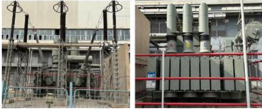
Fotoğraf 3.78 İskenderun santrali; Buşingi kırılan trafo ve yanal hareket eden trafo
