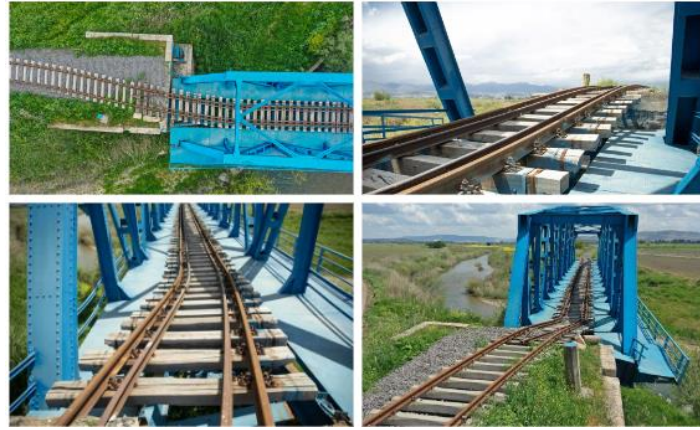
Fotoğraf 3.41 Demiryolu raylarında ve demir köprüde deformasyon
