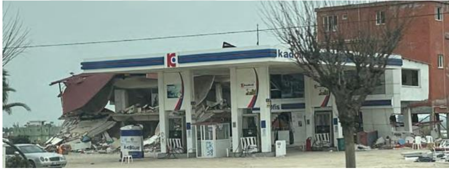
Fotoğraf 3.106 Ağır hasar görmüş benzin istasyonu örneği
