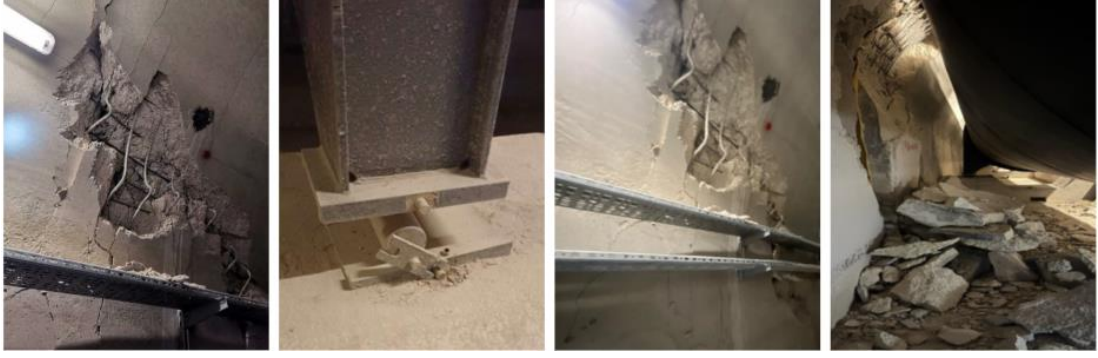
Fotoğraf 3.61 Tünelde ve boru desteğinde gözlemlenen hasarlar
