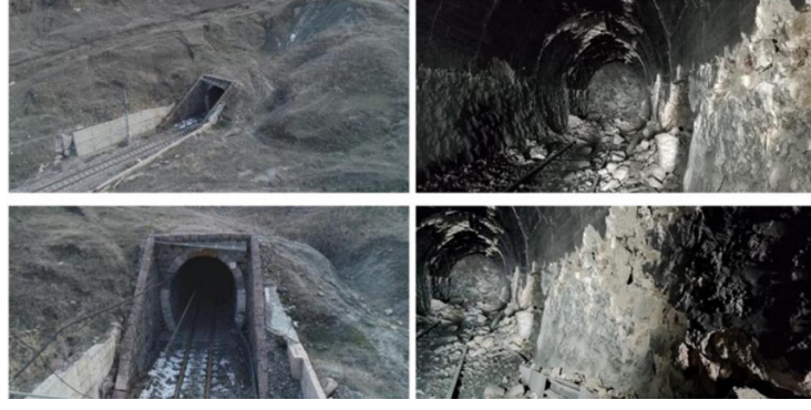
Fotoğraf 3.39 Taş kaplama demiryolu tüneline gözlemlenen yapısal hasarlar
