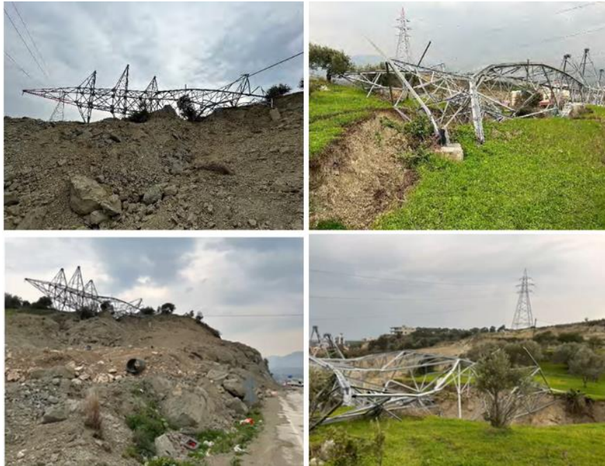
Fotoğraf 3.92 Devrilen elektrik iletim kulesi
