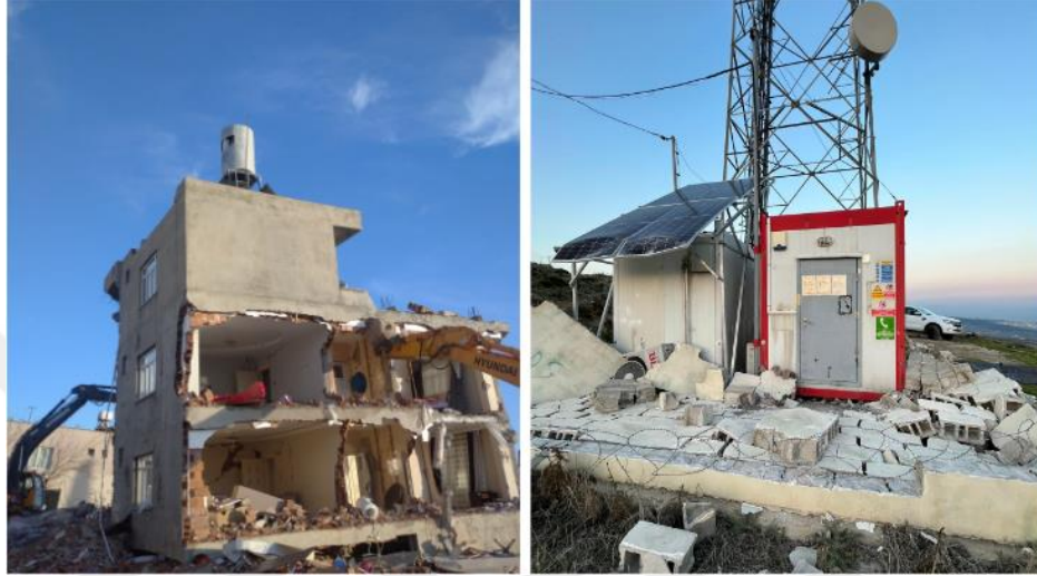
Fotoğraf 3.107 Depremde hasar gören baz istasyonları
