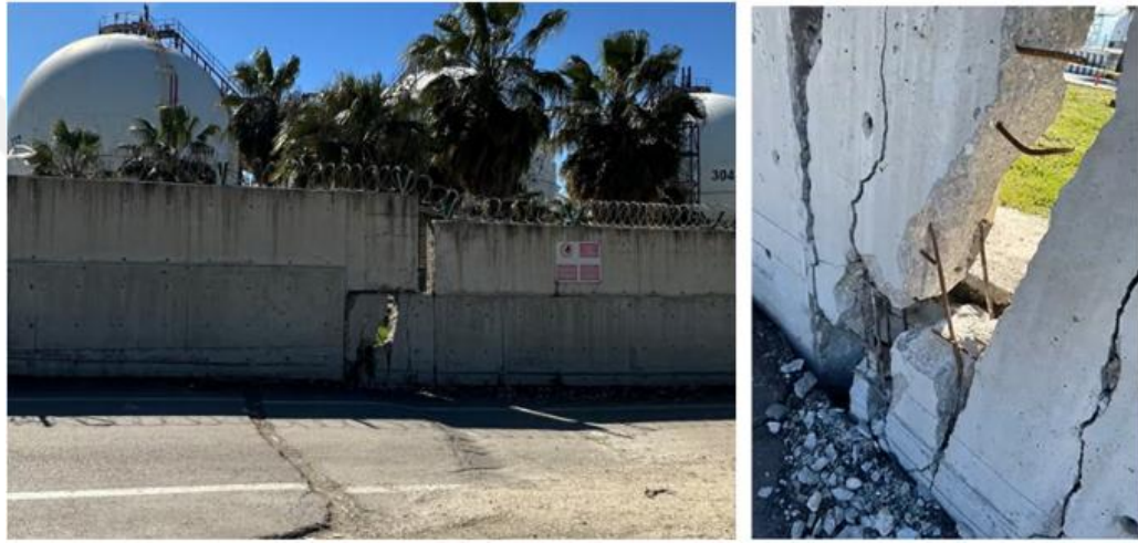
Fotoğraf 3.99 LPG terminalinin duvarlarında gözlemlenen hasar
