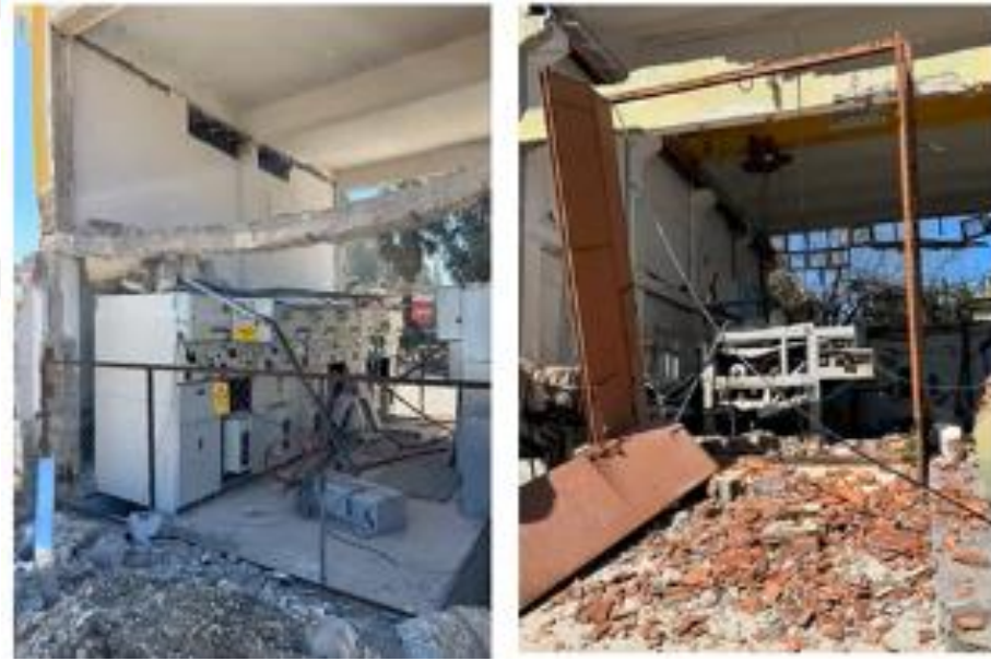
Fotoğraf 3.87 Trafo merkez binasında deprem sonrası gözlemlenen hasarlar
