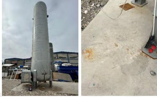
Fotoğraf 3.104 Sabitlenmemiş dikey tankın yanal olarak yer değiştirmesi
