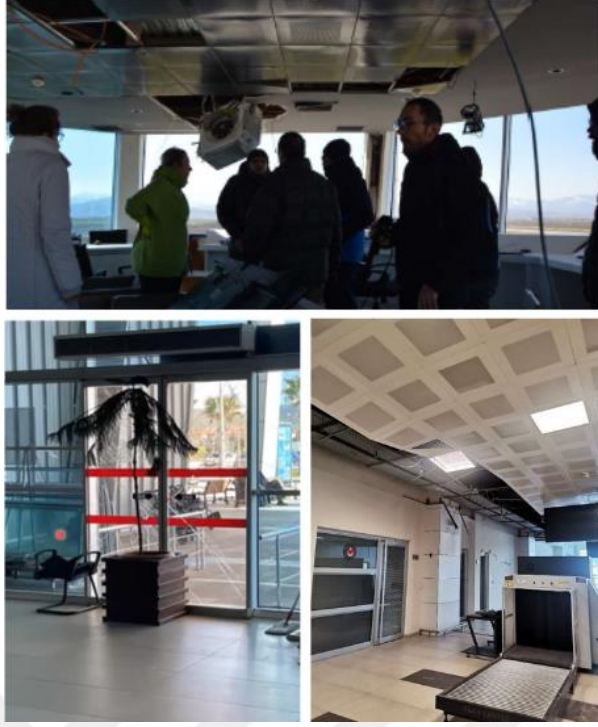
Fotoğraf 3.49 Kahramanmaraş Havalimanı'nda yapısal olmayan hasarlar
