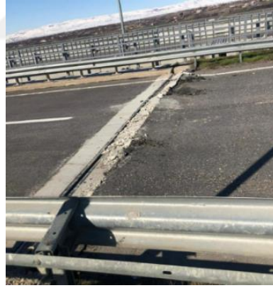
Fotoğraf 3.25 Köprünün genleşme derzinde gözlemlenen hasar
