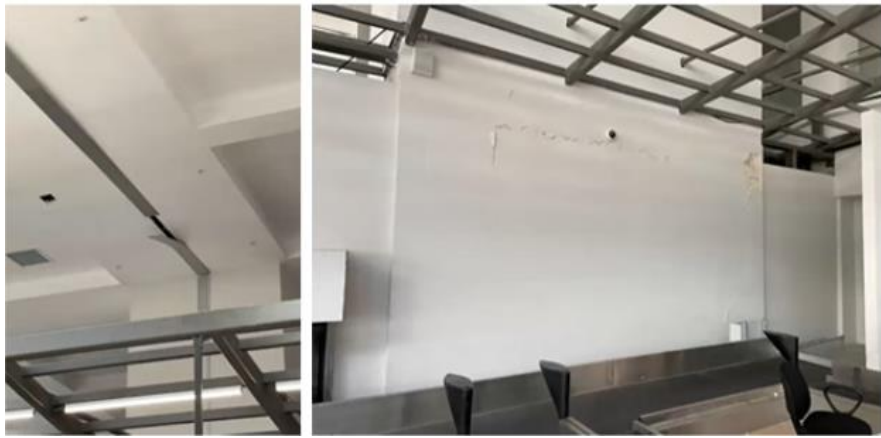
Fotoğraf 3.50 Gaziantep Havalimanı terminalinde yapısal olmayan hasarlar
