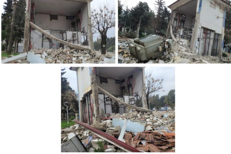
Fotoğraf 3.86 Trafo merkez binasında deprem sonrası gözlemlenen hasarlar
