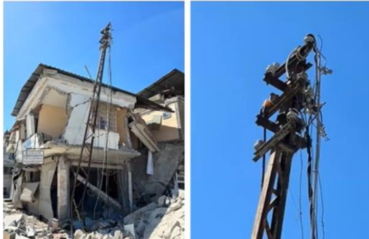
Fotoğraf 3.96 Antakya’da elektrik direğinin eğilmesi hasarı
