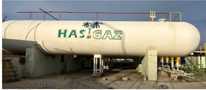
Fotoğraf 3.101 Depolama tankını destekleyen ayaklarda gözlemlenen çatlamlar
