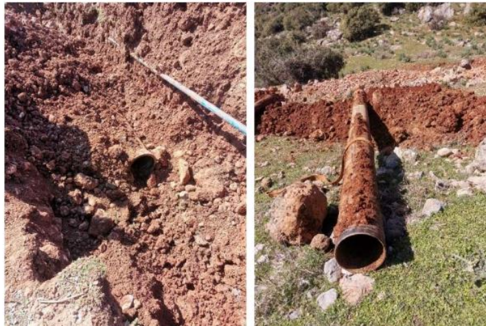
Fotoğraf 3.59 Düktil boru isale hattı bağlantı noktasında ayrılma
