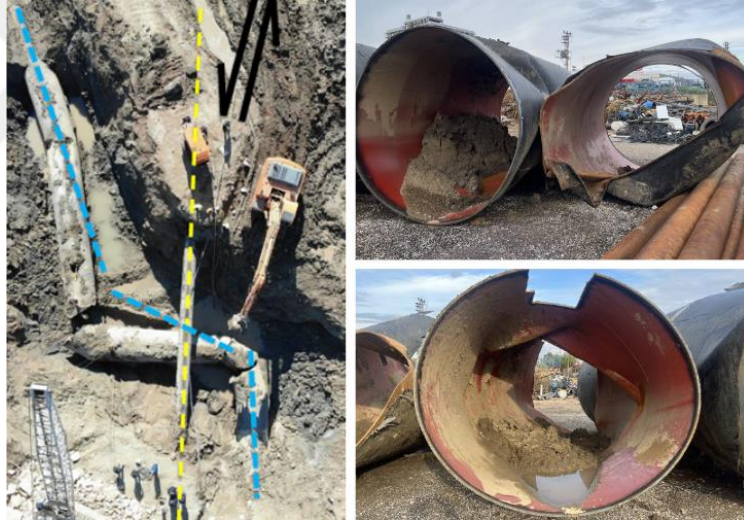
Fotoğraf 3.62 Fay hareketi nedeniyle su iletim borusunda gözlemlenen hasar
