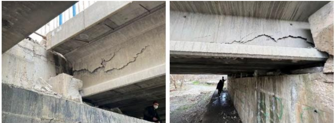
Fotoğraf 3.12 Kiriş uçlarında boylamsal çatlaklar
