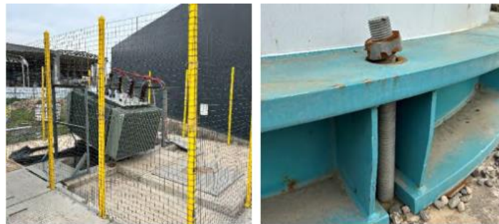
Fotoğraf 3.105 Hasar görmüş jeneratör ve deforme olmuş bağlantılar
