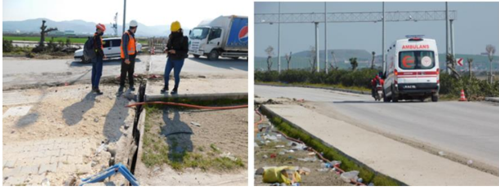
Fotoğraf 3.18 Köprü yaklaşım dolgusu oturması
