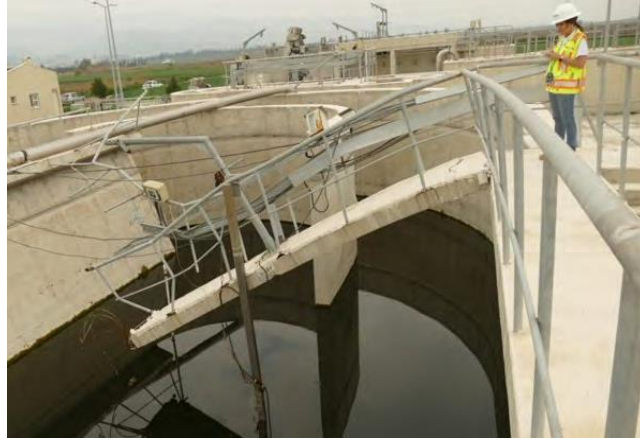
Fotoğraf 3.70 Kısmen çökmüş iç bölme duvar hasarı
