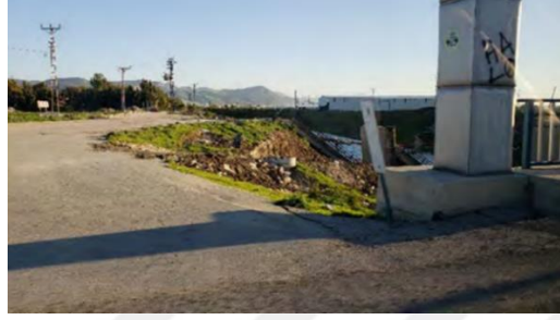
Fotoğraf 3.21 Hatay'daki bir köprüde gözlemlenen tabliye kayması sorunu
