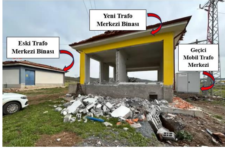
Fotoğraf 3.84 Eski ve yeni inşa edilmiş trafo merkezi binalarının hasar durumları
