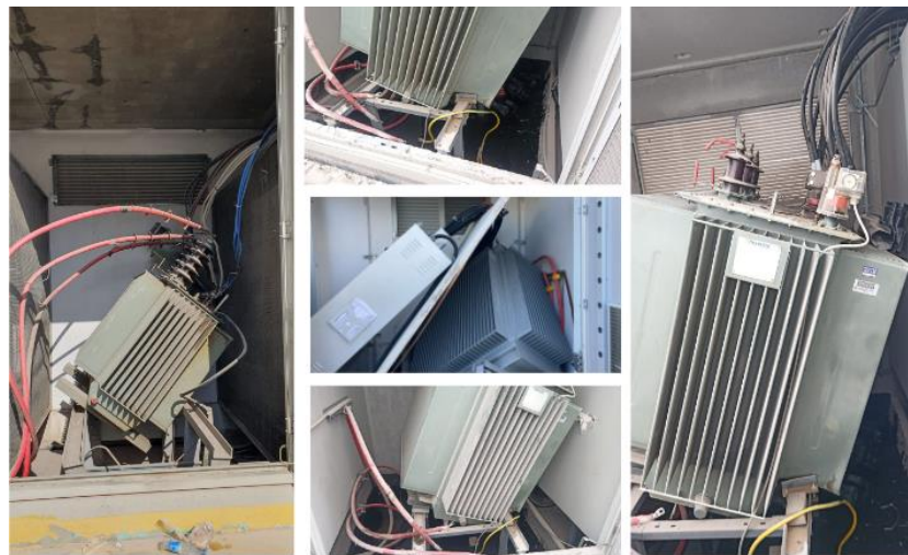
Fotoğraf 3.89 Yetersiz sabitleme nedeniyle devrilen trafo
