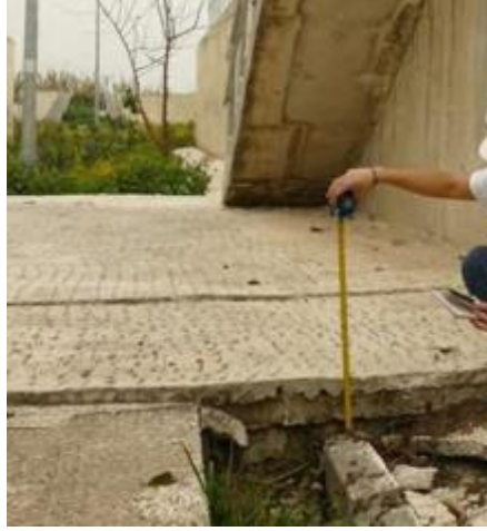
Fotoğraf 3.72 Tesiste gözlemlenen zemin oturma hasarı
