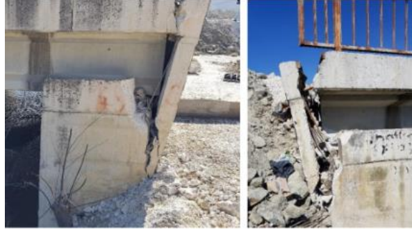
Fotoğraf 3.7 Köprü kenar ayak duvar hasarı
