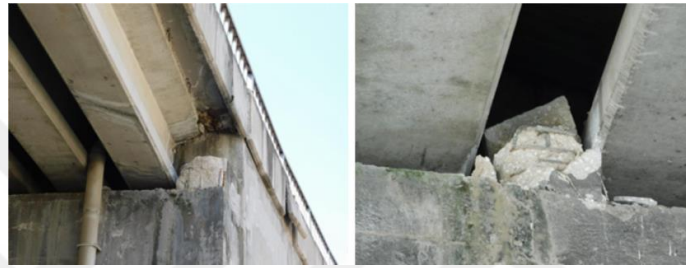
Fotoğraf 3.32 Dış deprem takozunda ve iç deprem takozunda gözlemlenen hasar
