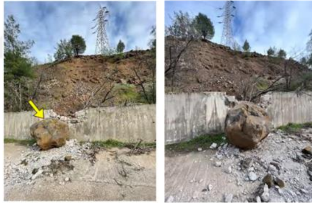
Fotoğraf 3.81 Menzelet barajında kaya düşmesi hasarı
