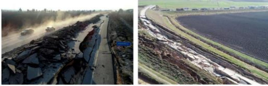
Fotoğraf 3.4 Deprem sonucu karayolunda oluşan derin çatlaklar ve göçmeler
