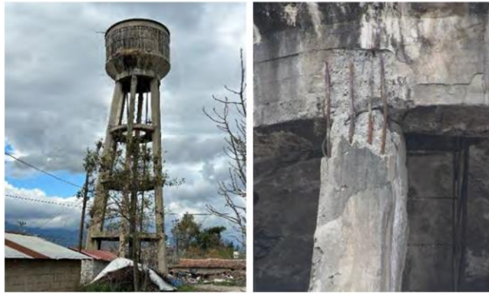
Fotoğraf 3.65 Hatay İçada'da hasar gören su kulesi
