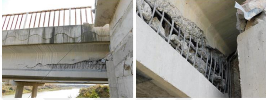
Fotoğraf 3.13 Öngermeli beton kirişlerin uç bölgelerinde gözlemlenen hasarlar
