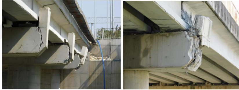
Fotoğraf 3.30 Kırılan dış deprem takozu ve giriş ucu hasarının yakından görünümü
