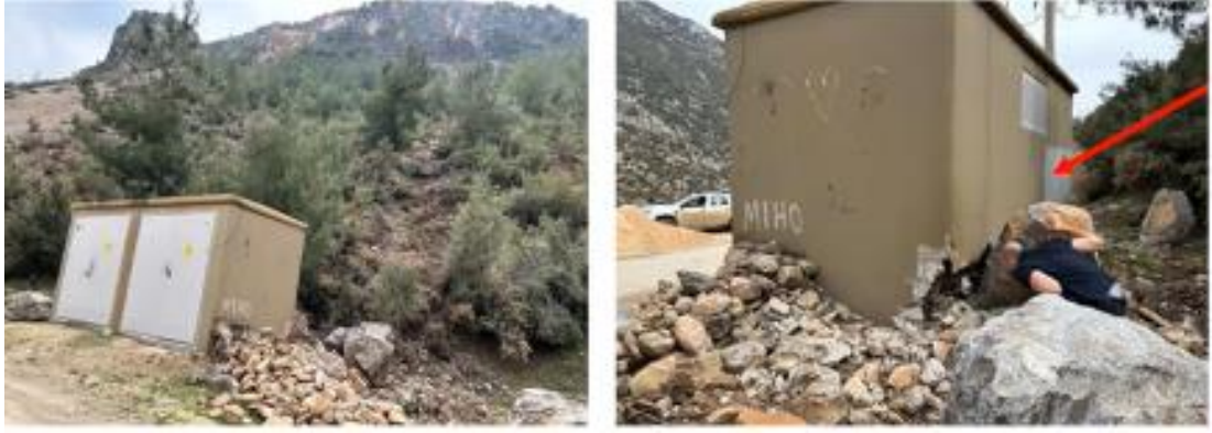
Fotoğraf 3.88 Düşen kayaların trafo merkezi binasına vermiş olduğu hasar
