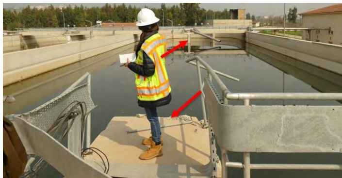
Fotoğraf 3.69 Havalandırma tankının iç bölme duvar hasarı
