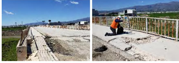
Fotoğraf 3.20 Köprü tabliyesinde gözlemlenen hasarlar
