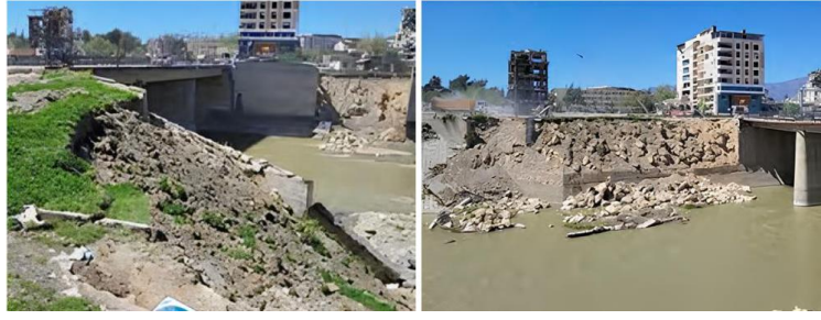
Fotoğraf 3.10 Köprü kenar ayak yaklaşım dolgusunun göçmesi
