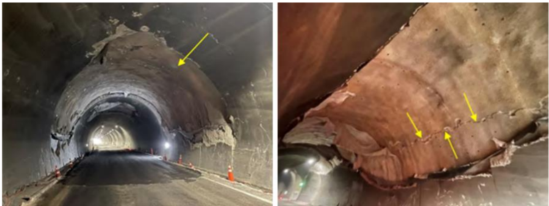
Fotoğraf 3.36 Erkenek Tünelinde gözlemlenen hasarlar
