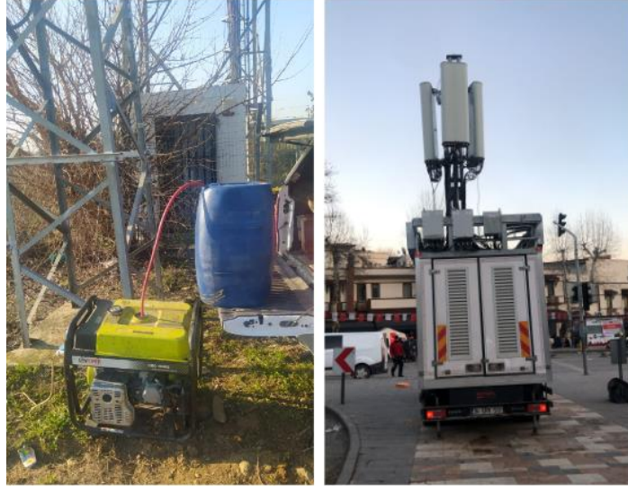
Fotoğraf 3.108 Afet bölgesine gönderilen jeneratör ve mobil baz istasyonu
