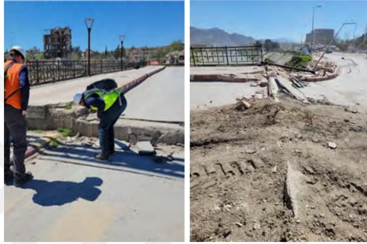
Fotoğraf 3.19 Bekir Karabacak Köprü tabliyesi hasarı
