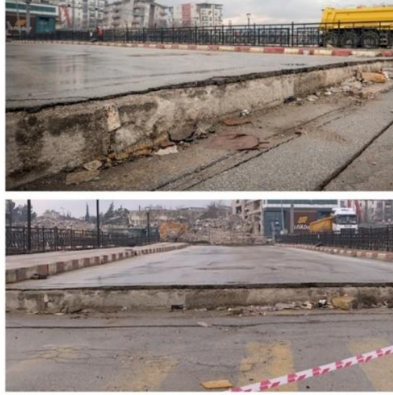
Fotoğraf 3.26 Deprem etkisiyle yukarı doğru hareket eden köprü
