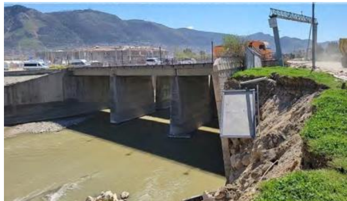
Fotoğraf 3.9 Köprü kenar ayak yaklaşım dolgusunun göçmesi
