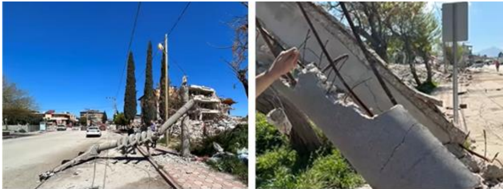
Fotoğraf 3.98 Antakya’da hasar gören beton direk
