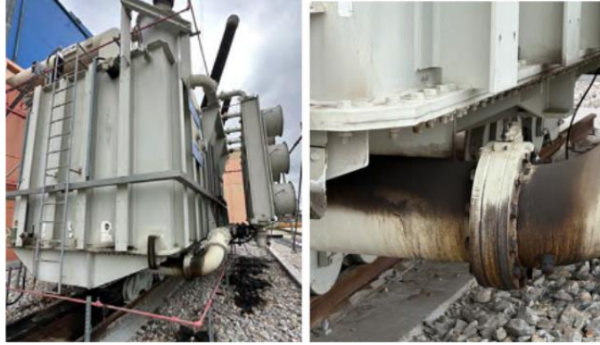
Fotoğraf 3.76 Afşin-Elbistan B Kömür Santrali trafosunda yağ sızıntısı hasarı
