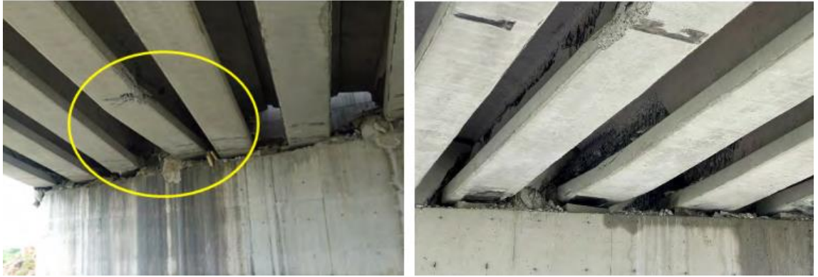
Fotoğraf 3.11 Ağır hasar görmüş beton köprü kirişleri
