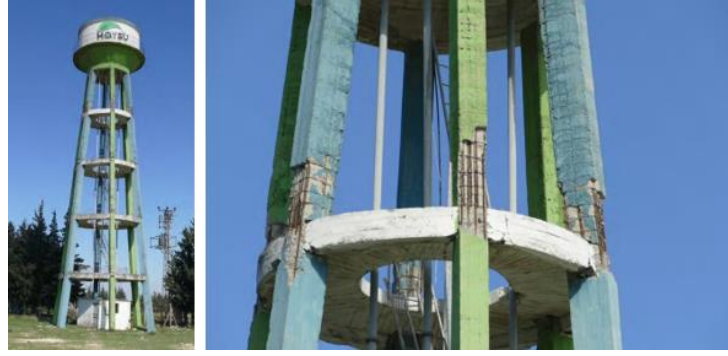
Fotoğraf 3.66 Hatay Antakya’da hasar gören su kulesi
