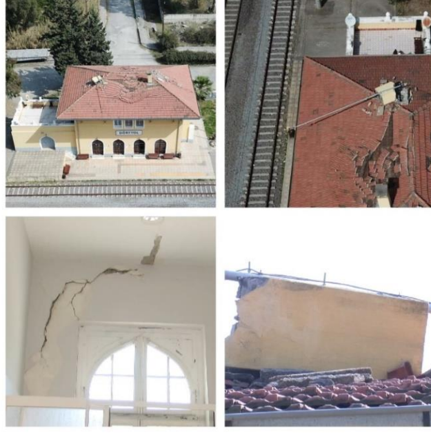
Fotoğraf 3.45 Dört Yol Tren İstasyonunda gözlemlenen hasarlar
