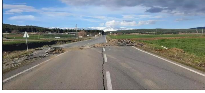
Fotoğraf 3.3 Fayın kestiği asfalt yol
