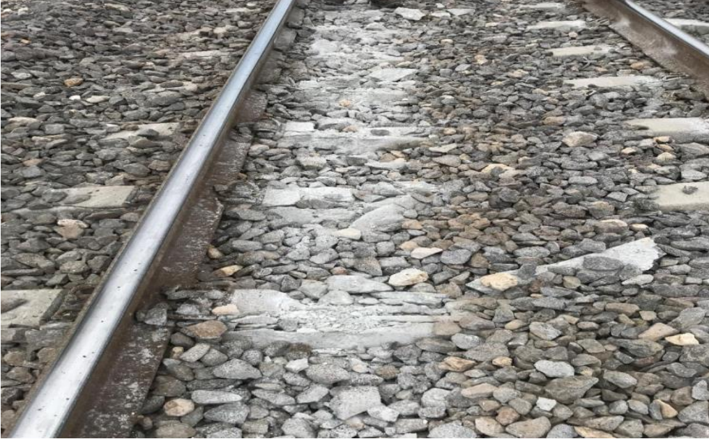
Resim 3.5. Deray sonucu hasarlanan demiryolu altyapısı (TCDD, 2021)
