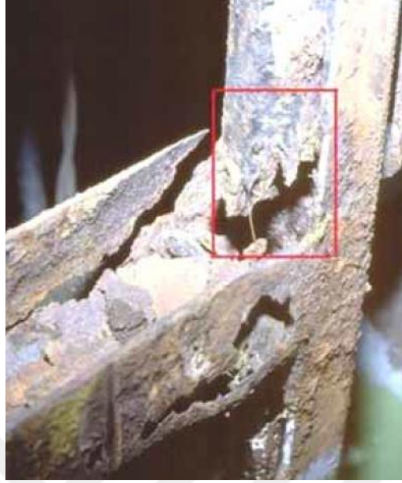
Şekil 2.3. Korozyon oluşumuna örnek (Gangopadhyay ve Mahanwar 2018)
