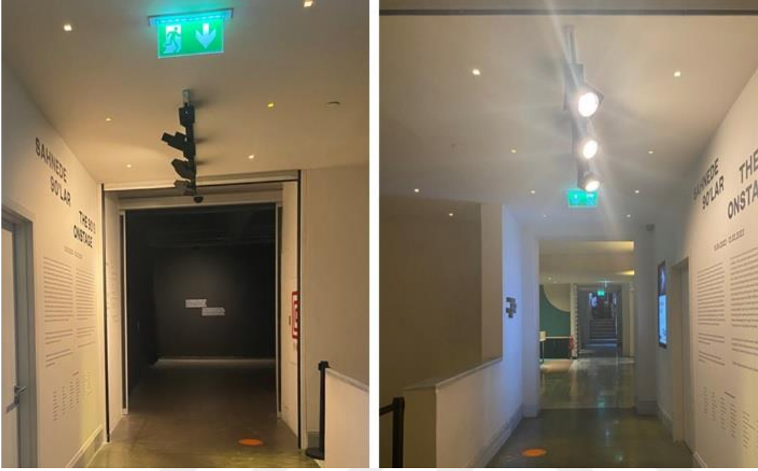
Şekil 138 Birinci bodrum kat koridor aydınlatmaları (Davutoğlu D., 2022)
