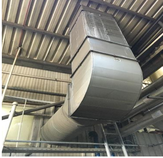
Şekil 3. 11. Kompresör odası yeni hava giriş-1
