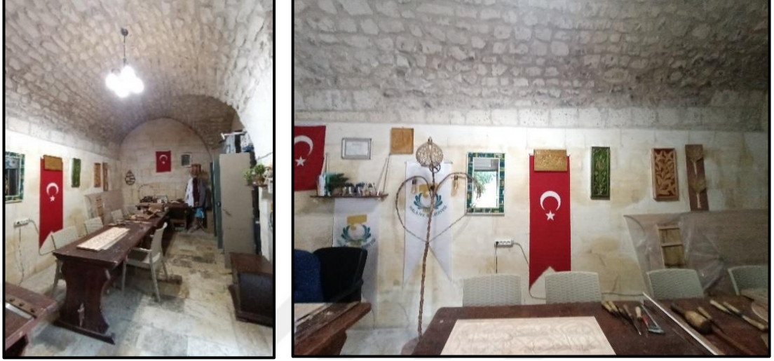
Şekil 4.80 ZK-11'in batı duvarındaki nemlenmeyi kapatmak için yapılan muhdes taş kaplama (Yazar arşivi, 2022)
