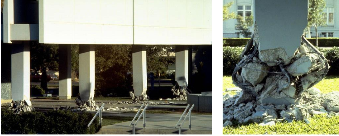
Şekil 1.5 : 1979 Imperial Valley depreminde hasar gören Imperial County hizmet binasında görülen kolon hasarları (NISEE).
