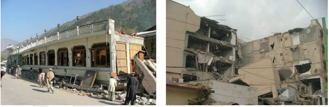
Şekil 1.1 : 2005 Keşmir (Pakistan) depremi sırasında yumuşak kat nedeniyle oluşan hasarlar (MAE, 2005).
