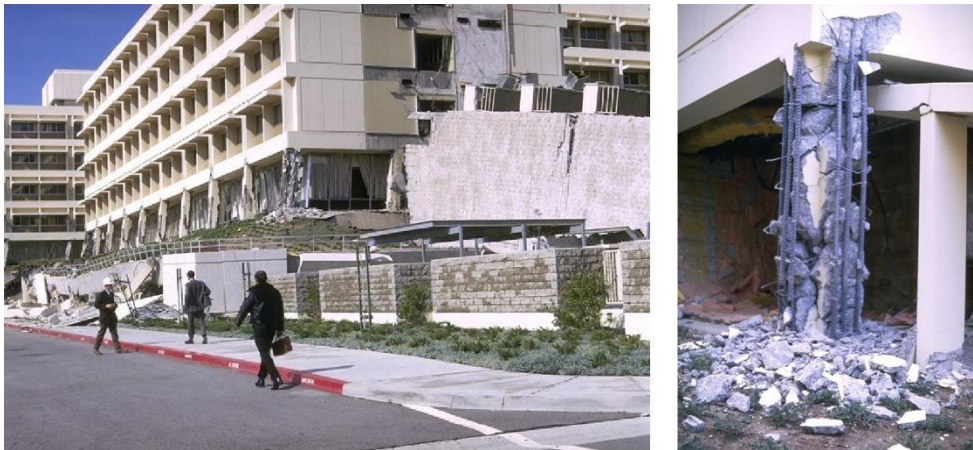
Şekil 1.4 : 1971 San Fernando depreminde Olive View Hastanesi binasında görülen kolon hasarları (NISEE).
