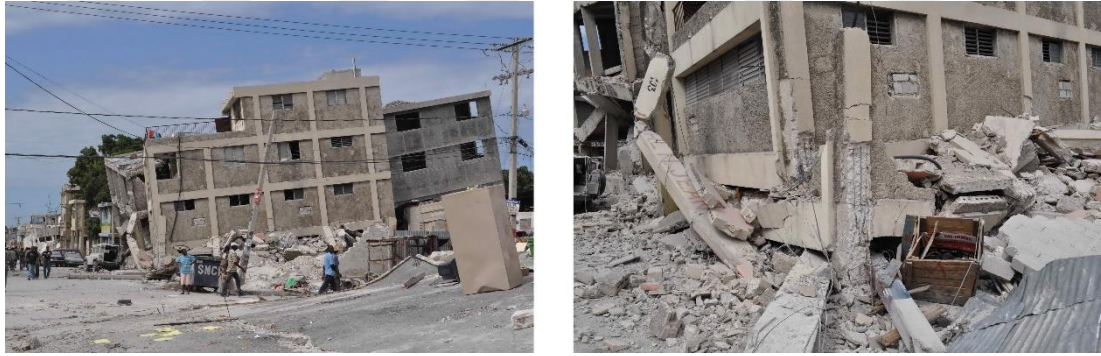
Şekil 1.2 : 2010 Haiti depremi sırasında 5 katlı betonarme binada alt iki katın göçmesi (USGS/EERI, 2010).
