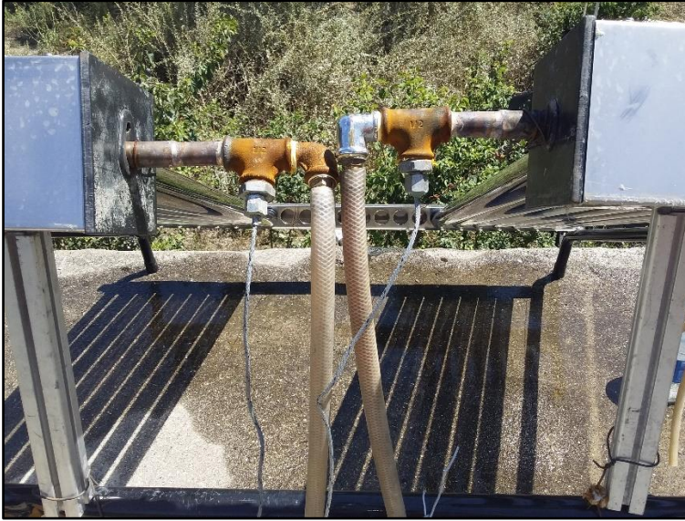
Resim 7.7. Isı borulu vakum tüplü güneş kolektörü termokupl bağlantıları
