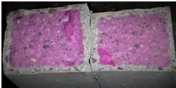
Şekil 2.3. Karbonatlaşma meydana gelen harç numuneleri [Özcan ve Atiş, 2017]
