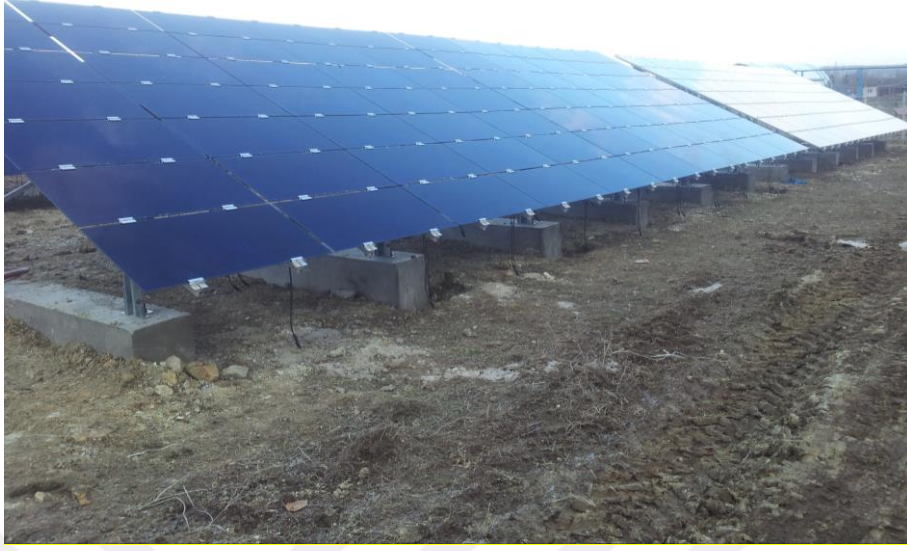
Şekil 3.3. Montajı tamamlanmış FV paneller.
