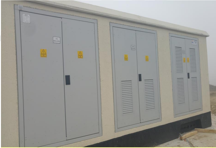
Şekil 3.4. Şehzade Park GES transformatör odası.
