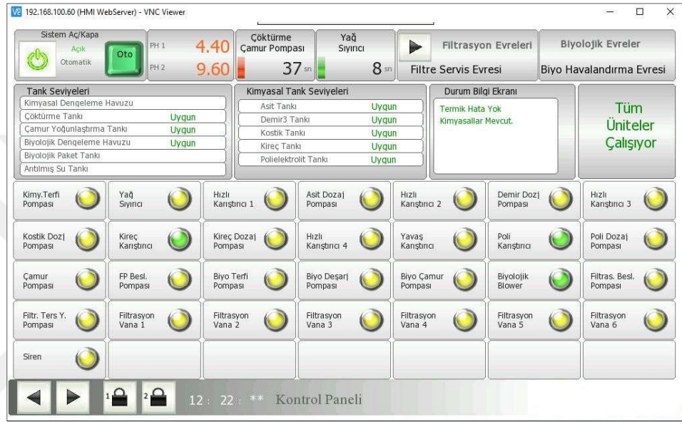
Şekil 5.8: Arıtma Tesisi PLC ekranı.
