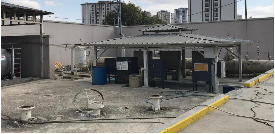
Şekil 3.7 : Koku kimyasalını doğalgaz boru hattına dağıtım ünitesi.
