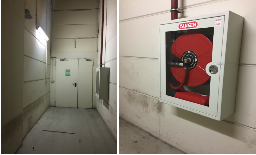
Şekil 5.28: Kaçış güzergahı üzerinde bulunan yangın söndürme ekipmanlarının bulunduğu yerlerde sağlanan aydınlatma.
