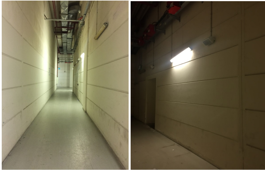
Şekil 6.4: AVM TİP 3 acil kaçış güzergahı koridoru hattında uygulanan aydınlatma armatürleri.
