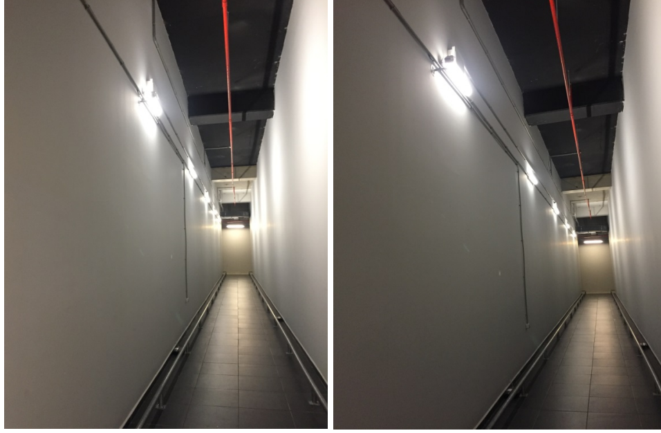
Şekil 6.3: AVM TİP 2 acil kaçış güzergahı koridoru boyunca duvara monte aydınlatma armatürleri.
