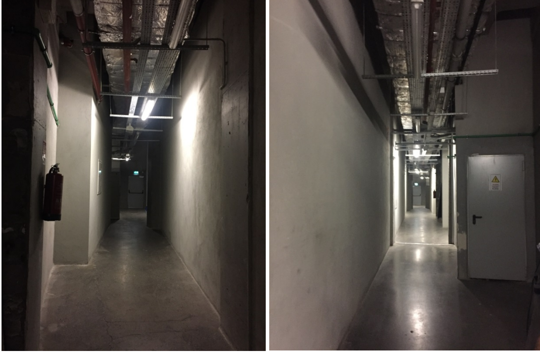
Őekil 6.2: AVM TİP 1 acil kaçıŐ gűzergahı koridoru hattında uygulanan aydınlatma armatűrleri.
