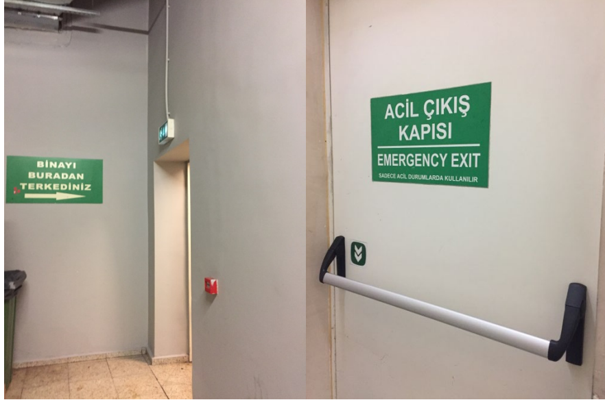
Şekil 6.1: Acil kaçış güzergahında kaçış yönlendirme bilgilerinin yeşil zemin üzerine beyaz yazı ile yazılması.
