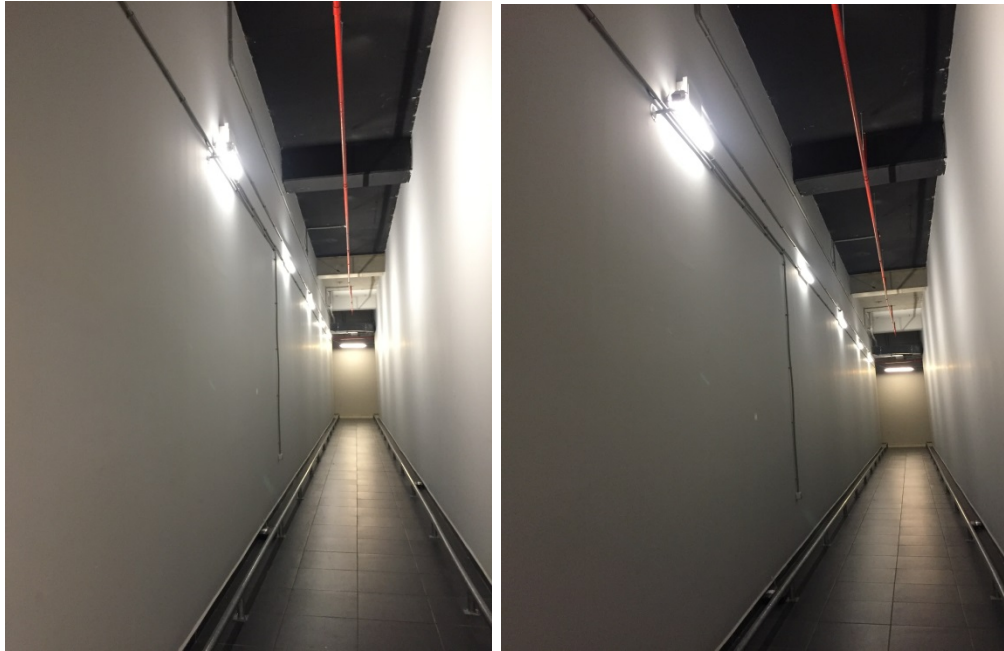
Şekil 5.23: Acil kaçış güzergahı koridoru boyunca duvara monte aydınlatma armatürleri.
