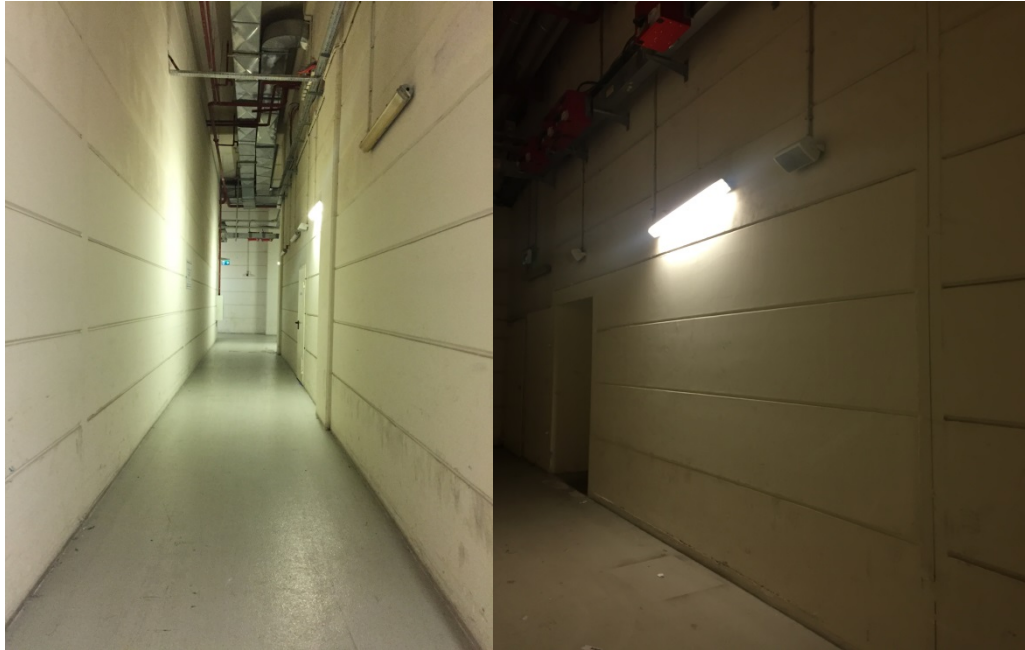
Şekil 5.29: Acil kaçış güzergahı koridoru hattında uygulanan aydınlatma armatürleri.
