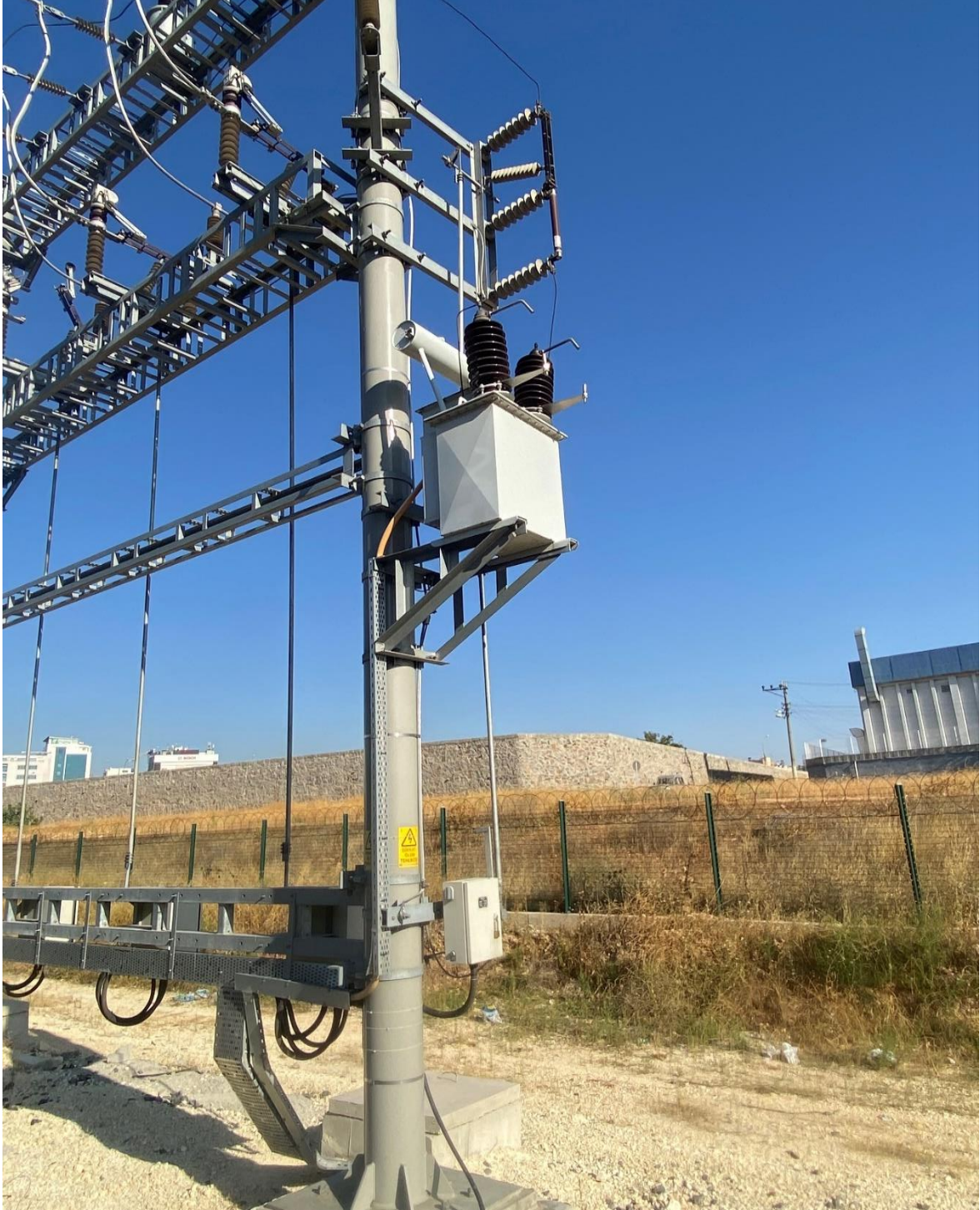
Şekil 3.20 Katener yardımcı servis trafosu
