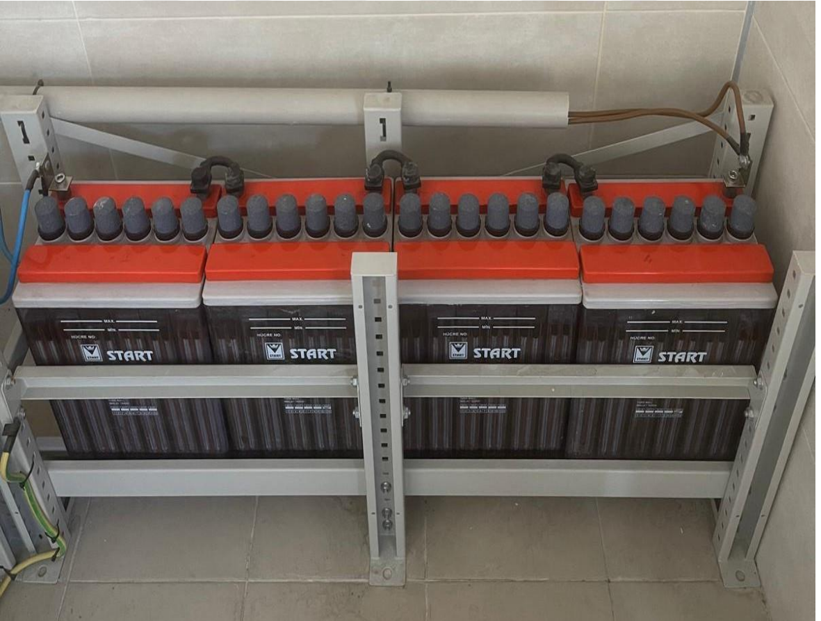
Şekil 5.7 İstasyon postası 48v akü grubu
