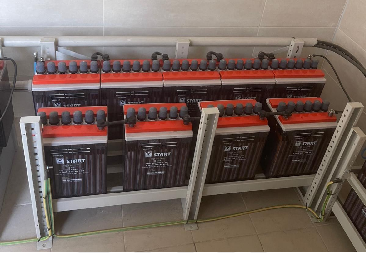
Şekil 5.6 İstasyon postası 110v akü grubu
