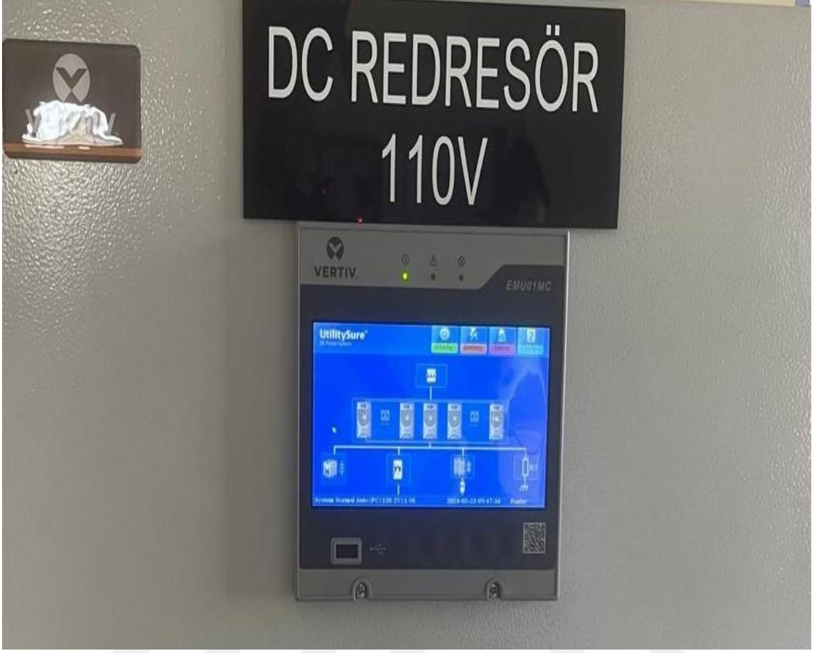
Şekil 5.8 110v Dc redresör
