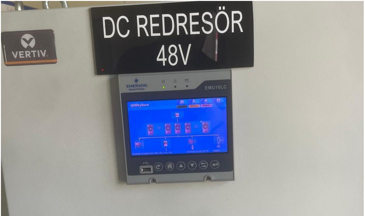
Şekil 5.9 48v Dc redresör
