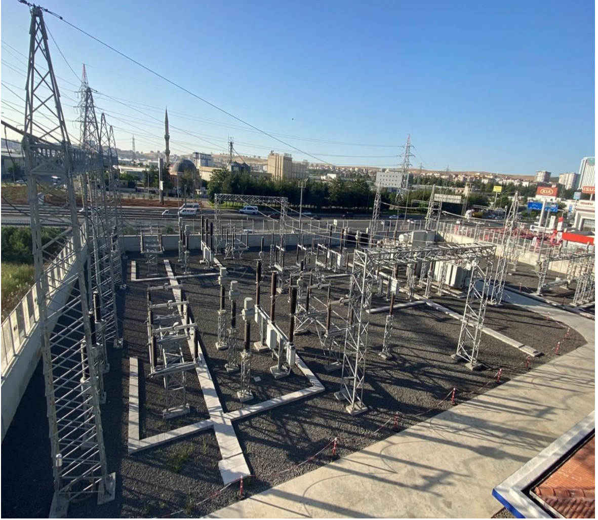
Şekil 2.4 Trafo merkezi genel görünümü
