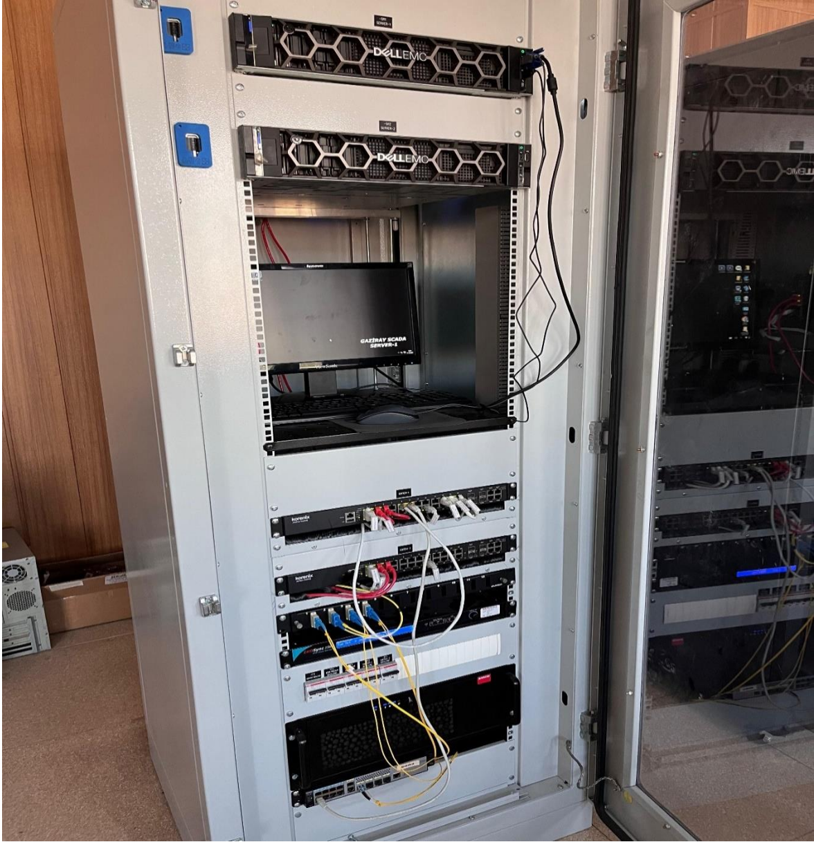
Şekil 2.7 Server ve sunucu kabini
