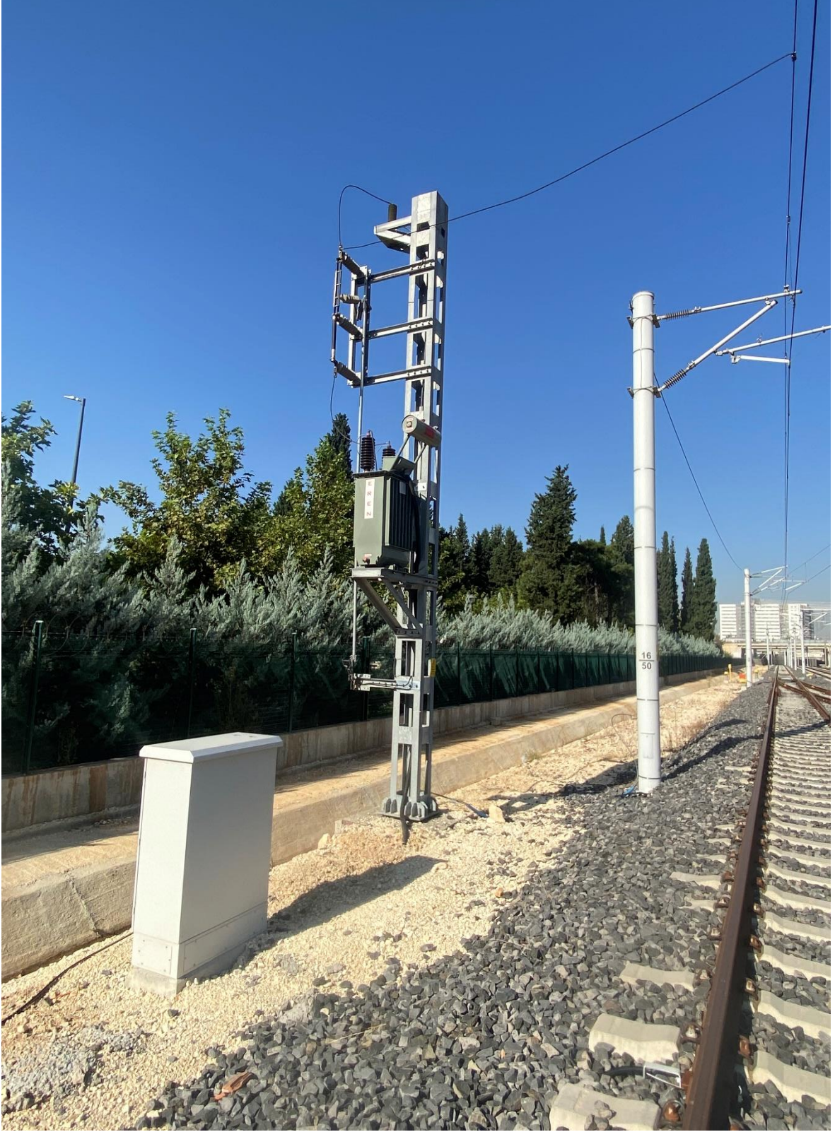
Şekil 3.21 Makas ısıtıcısı yardımcı servis trafosu ve kabini
