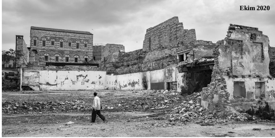
Görsel 166. İstanbul Surları_112. Edirnekapı’da bulunan Tekfur Sarayı’nı çevreleyen duvarlara ve devamında uzanan surlara bitişik olarak yapılmış otopark yıkıldı; ancak oluşan zararın izleri duvarlarda okunuyor ve burası halen restore edilmeyi bekliyor.
