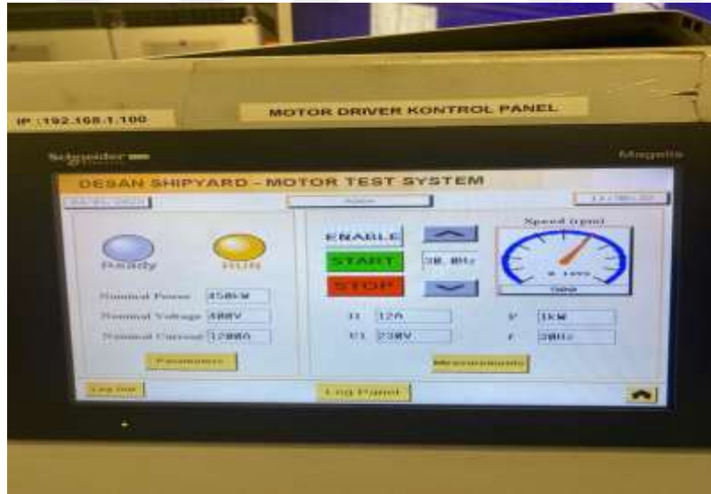
Şekil 3.15: 400V-50Hz/440V-60Hz Scada Dokunmatik Sürücü Kontrol Paneli- [Desan Tersanesi]
