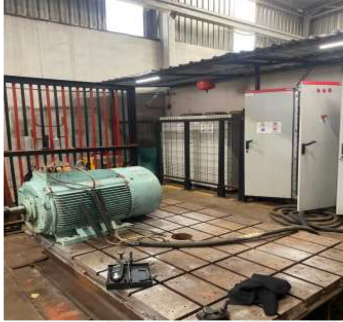
Şekil 3.14: Motor ve Topraklanmış Test Sehpası – [Desan Tersanesi]
