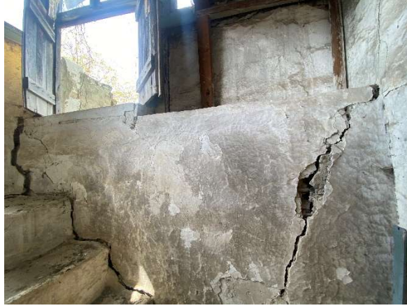
Fig. 33. Merdivende görülen çatlaklar
