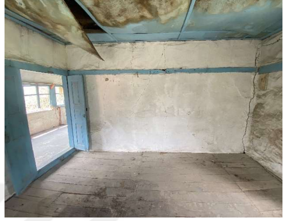
Fig. 38. Kuzeybatı köşedeki çatlak
