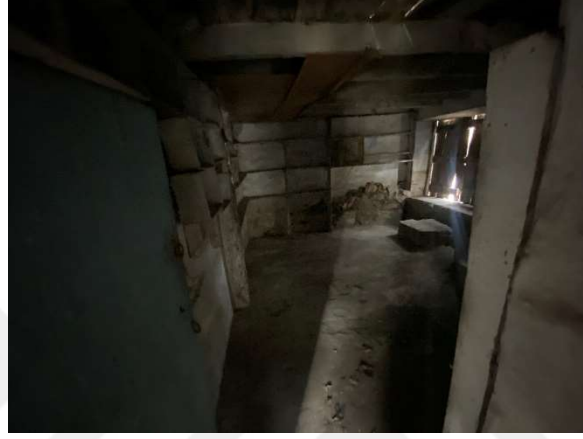
Fig. 32. Ahşap rafların durumu
