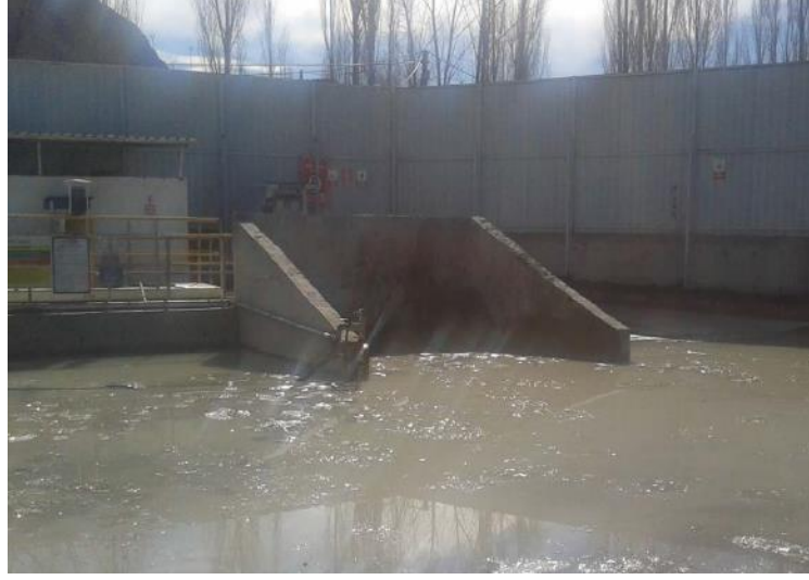
Şekil 3.17. Kapasitesi yetersiz kalmış çöktürme havuzu örneği [Güner, 2018].
