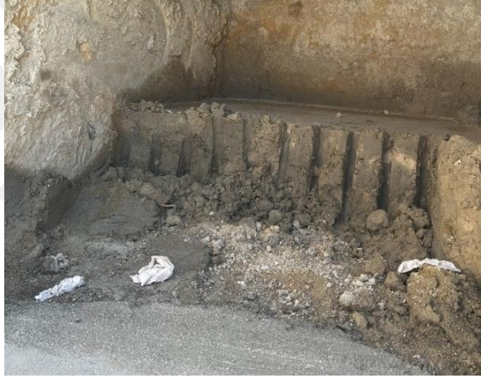
Şekil 3.15. Çöktürme havuzu dibinde biriken beton sedimenti (dip çamuru) (Z. Turan arşivi).
