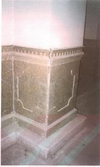
Resim 4.5. Zemin kattaki ayakdaki mermer kaplamanın deprem sonrası dışa atması
