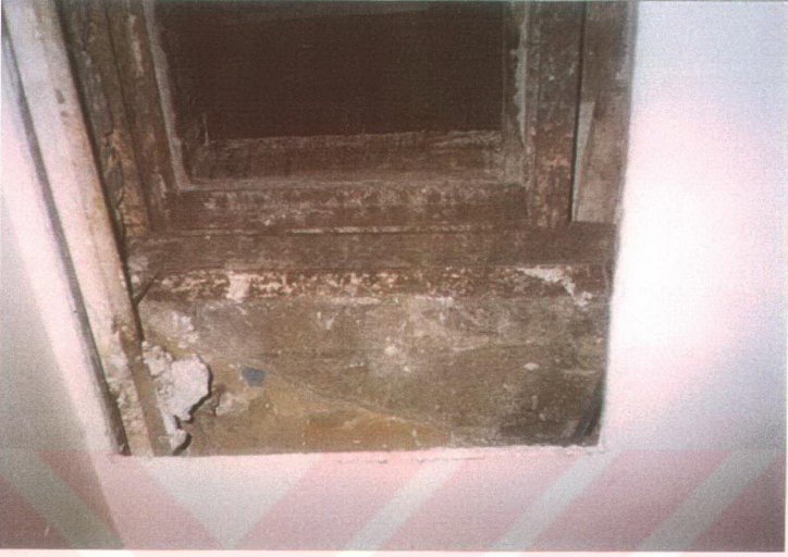
Resim 4.8. Çatı çıkış kapağındaki putrellerde korozyon
