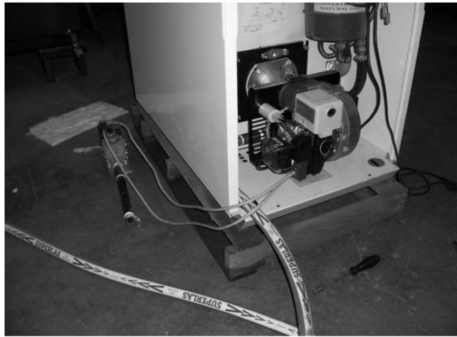
Şekil 4.9: Doęalgaz brölörlü kazan ve bağlantı elemanlarının görönümü
