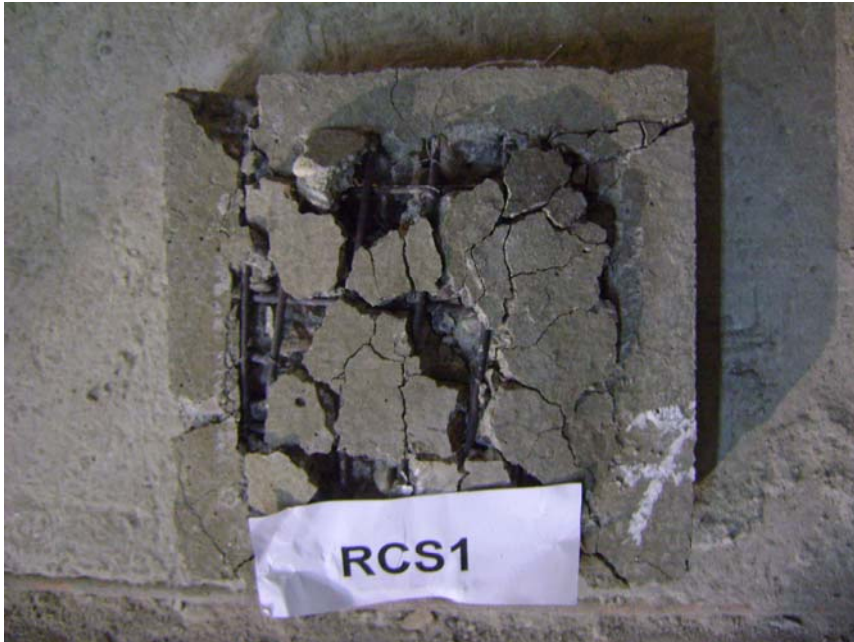
Şekil 3.16. RCS 1 numunesinin atlak dađılımları
