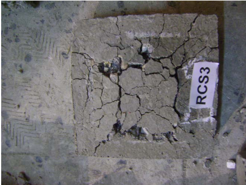
Őekil 3.18. RCS 3 numunesinin atlak dađılımı
