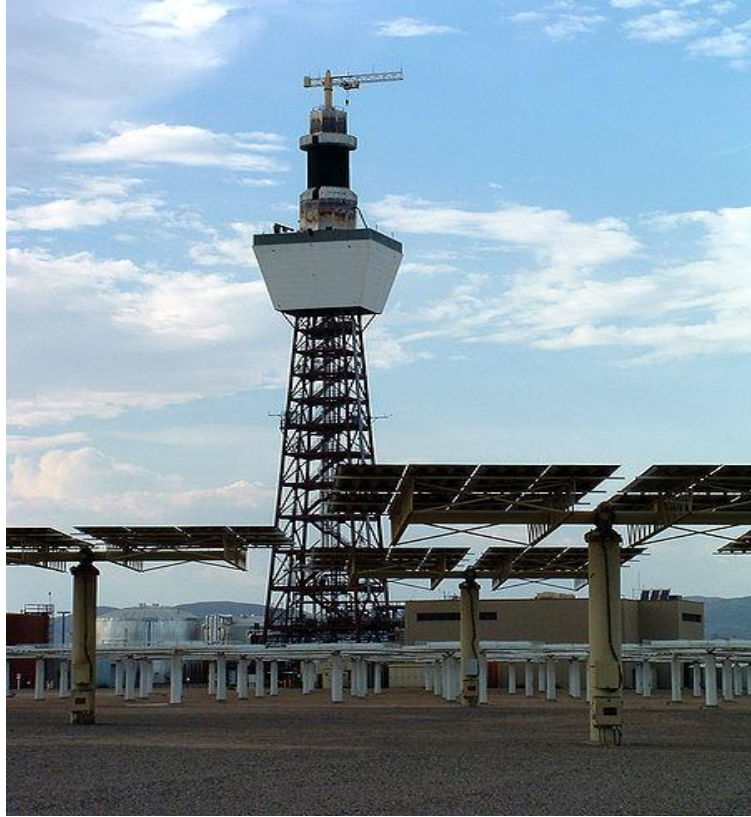
Şekil 1.2: Sıvı fazda tuz ile çalışan Sierra Güneş Enerjisi Kulesi Lancaster California.
