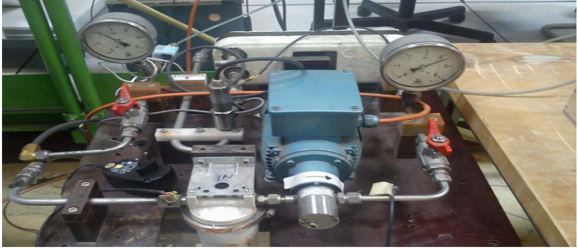
Şekil 4.3. RBX Sisteminin Soğutucu Ünitesi.
